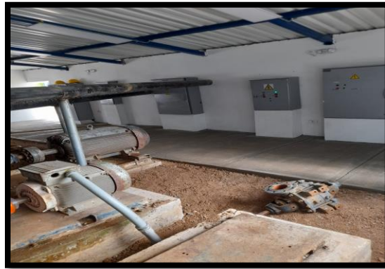
Figura 21. Tableros de mandos eléctricos
