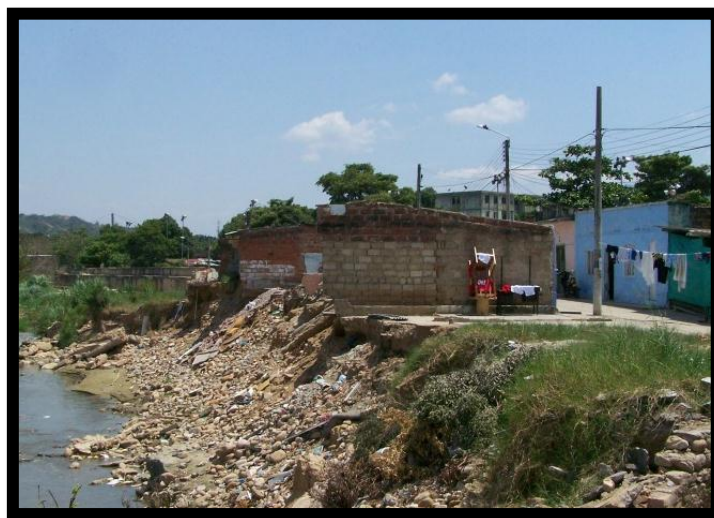
Fotografía tomada por: Denise Ortiz Figura 3 Deterioro de las márgenes
