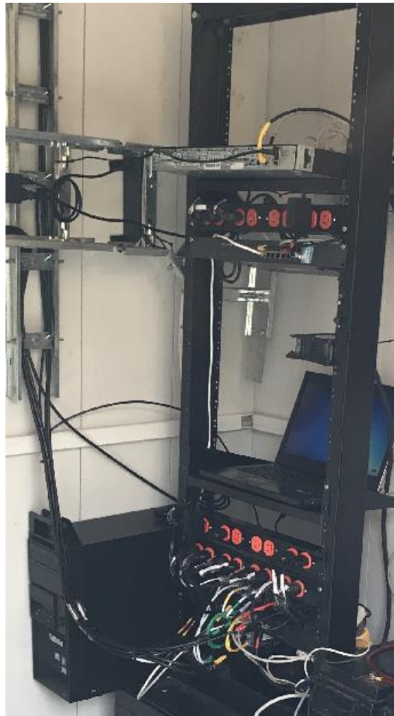
Figura 22. Infraestructura de Red, fuente autor del proyecto
