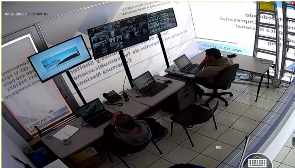
Figura 24. NOC, fuente autor del proyecto
