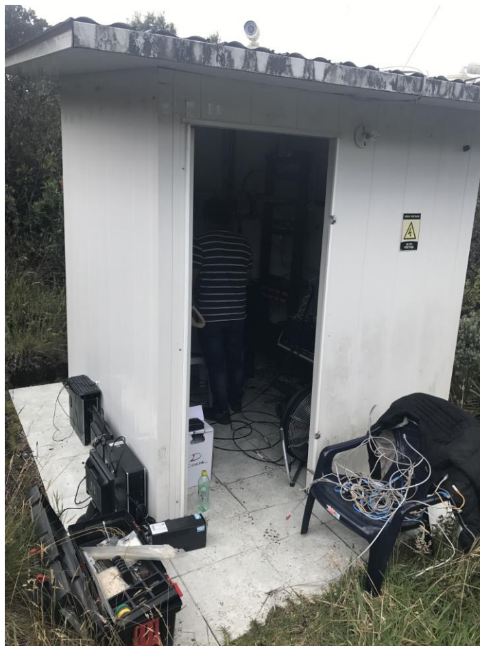
Figura 21. Infraestructura de Red, fuente autor del proyecto
