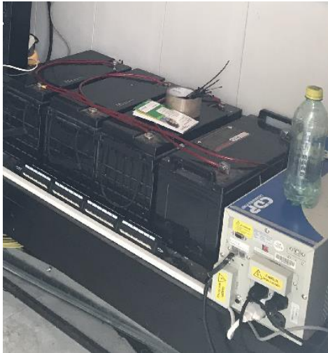
Figura 23. Infraestructura de Red, fuente autor del proyecto
