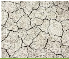
GRIETAS DE COCODRILO
