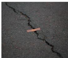
GRIETAS DE LA JUNTA DE CARRIL
