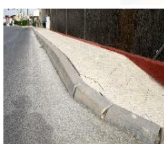
GRIETAS DE LA JUNTA DEL BORDILLO
