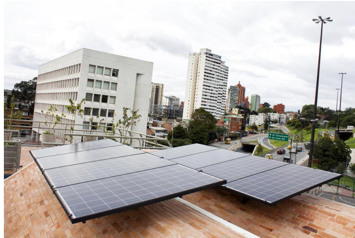
Figura 1. Sistema de energía solar fotovoltaica, Universidad Jorge Tadeo Lozano, Bogotá, Adaptado de Periódico el Espectador [43]
