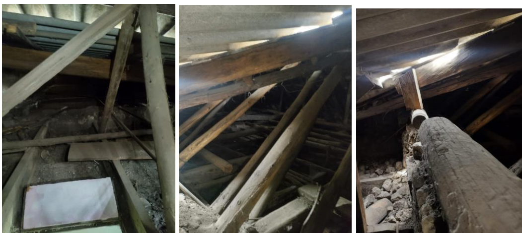
Ilustración 16 Cubierta en deterioro Fuente: Propia
