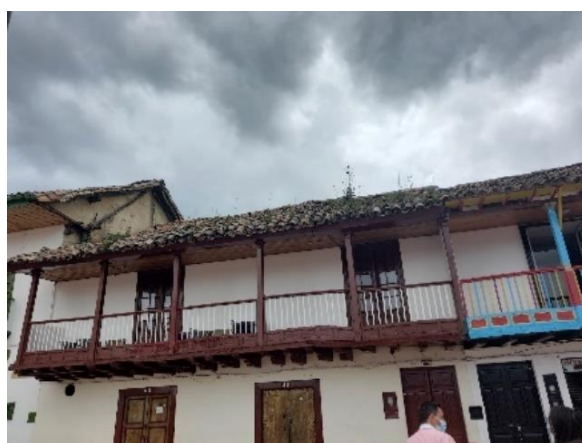
Ilustración 17 Ondulación en balcón Fuente: Propia
