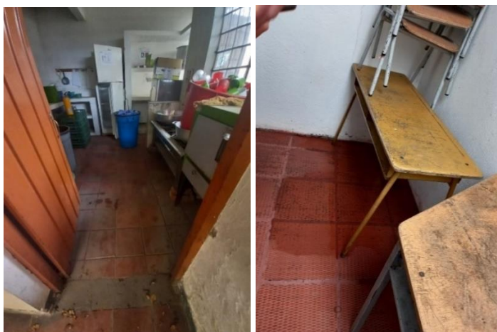
Ilustración 14 Afectaciones por cubierta
