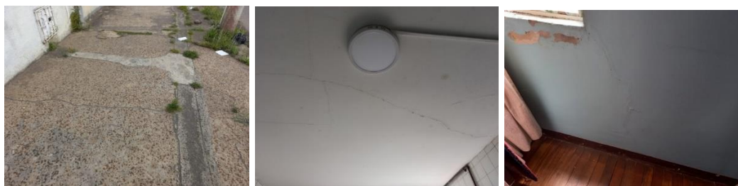
Ilustración 23 Daños en las viviendas Fuente: Propia
