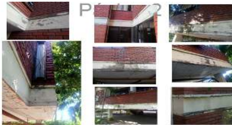
Imagen 6. Afectaciones en los entrepisos del edificio Bosque de Tamarindos Fuente: Ing. Jessica Ospina – Ing. Fabián Velásquez estudio patológico
