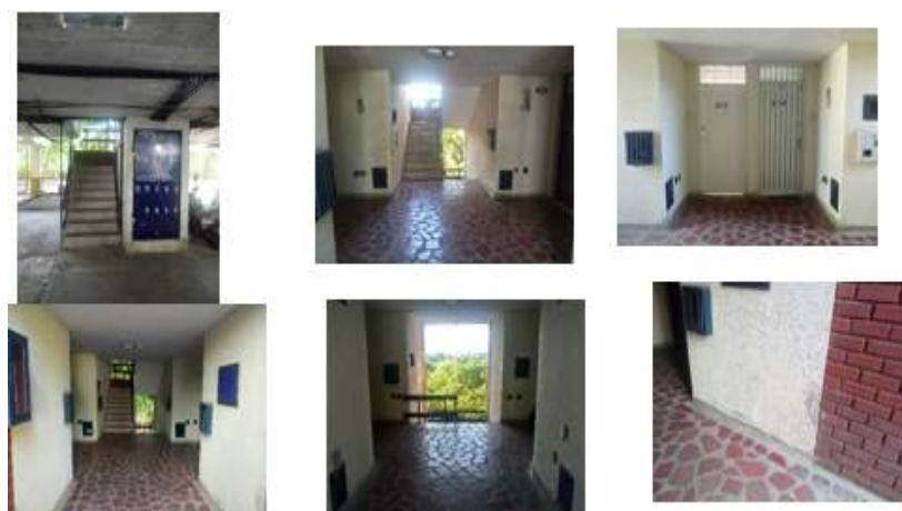
Imagen 8. Afectaciones en las zonas comunes edificio Bosque de Tamarindos Fuente: Ing. Jessica Ospina – Ing. Fabián Velásquez estudio patológico
