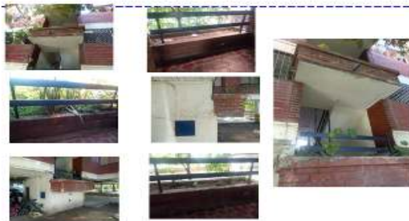
Imagen 7. Afectaciones en la jardinería del edificio Bosque de Tamarindos Fuente: Ing. Jessica Ospina – Ing. Fabián Velásquez estudio patológico
