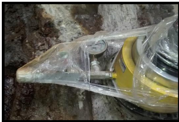
Fotografía 10 celdas de control de presión.
