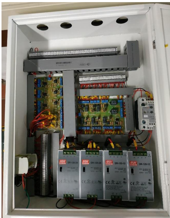
Figura 36. Tablero de circuitos y potencia. El Autor
