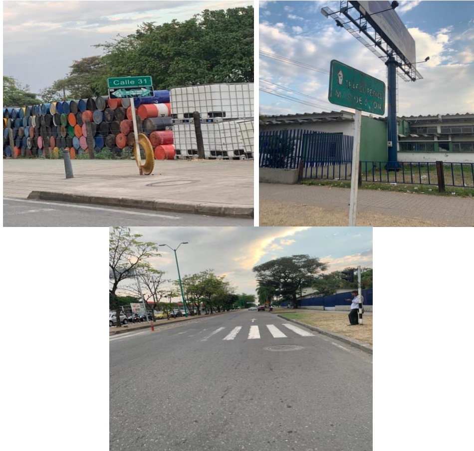
Ilustración 7.42. Señales de tránsito en mal estado. Fuente: Elaboración propia.
