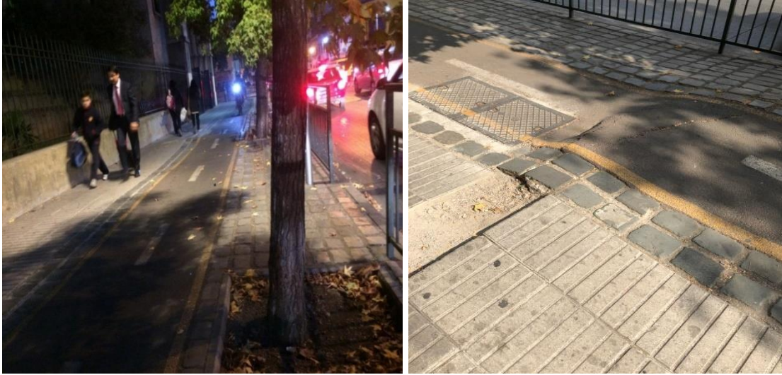
Ilustración 7.4 Sobreelevación en la capa asfáltica de la ciclo vía. Fuente: Elaboración propia.
