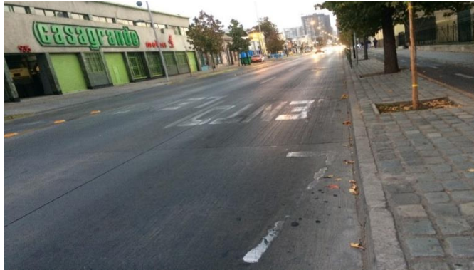
Ilustración 7.7 Demarcación Horizontal en el pavimento en mal estado Fuente: Elaboración propia.
