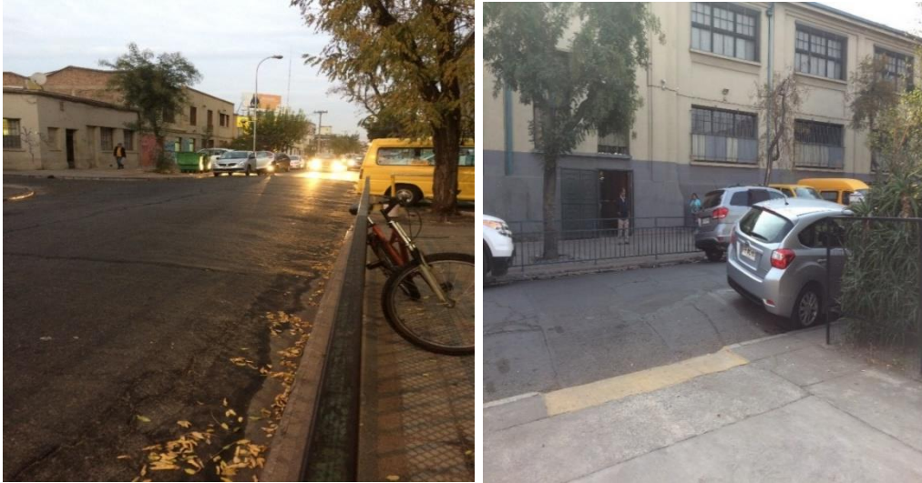
Ilustración 7.10 Pavimento en mal estado, presentando desnivel representativo en las zonas laterales de la vía.
