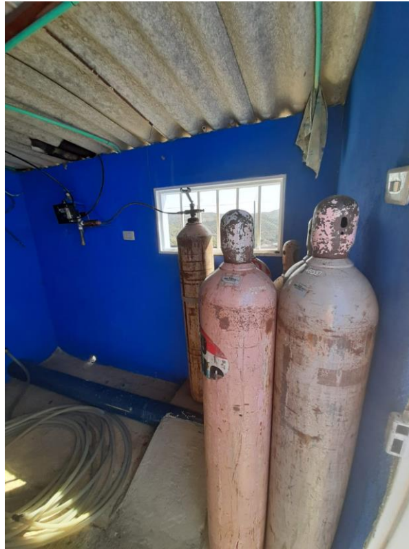
Figura 2. Balas de cloro gaseoso dentro del almacén de clorador. Información adaptada de la planta del acueducto de la empresa EMCAR A.P.C.
