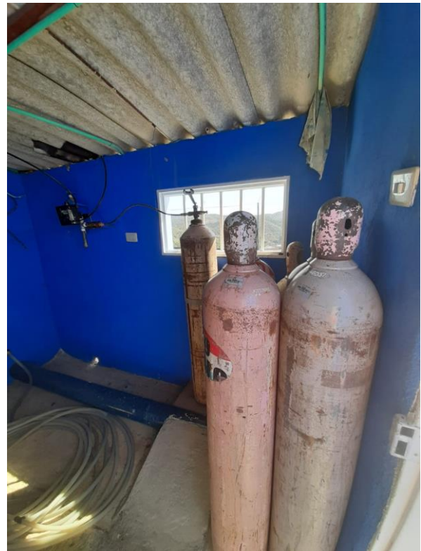
Figura 14. Almacén de clorador. Información adaptada de la planta del acueducto de la empresa EMCAR A.P.C.
