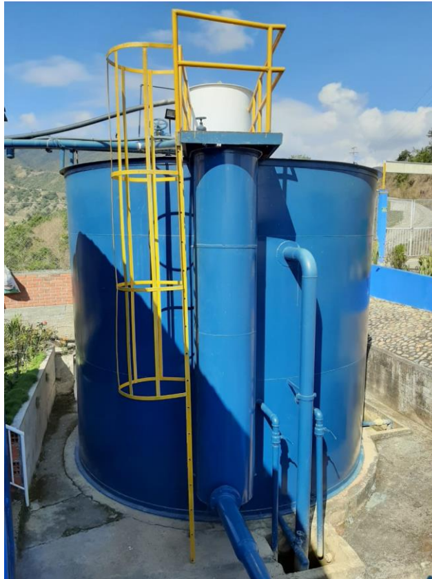
Figura 12. Planta de tratamiento, tanque clarificador. Información adaptada de la planta del acueducto de la empresa EMCAR A.P.C.
