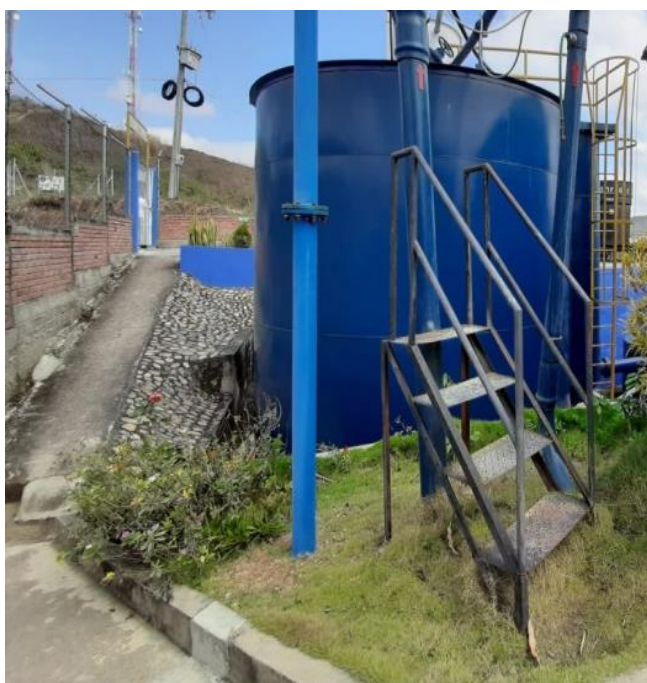
Figura 37. Comienzo de la ruta de transporte de la carga. Información adaptada de la planta del acueducto de la empresa EMCAR A.P.C.
