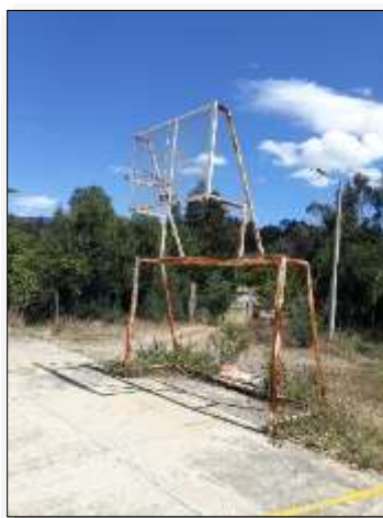
Figura 23. Evidencia fotográfica corrosión en pintura
