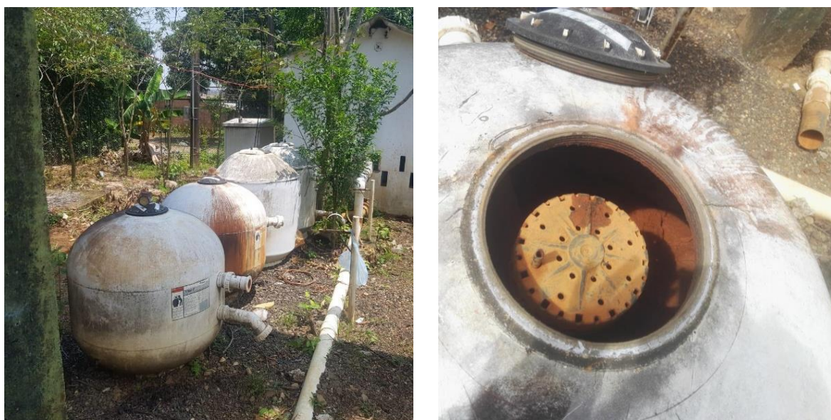
Figura 11. Batería de Filtros.
