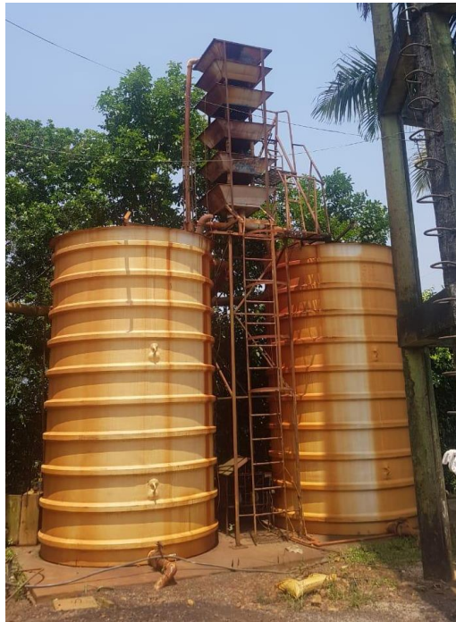
Figura 9. Floculadores de flujo ascendente. Fuente: Autoría propia, 2019.
