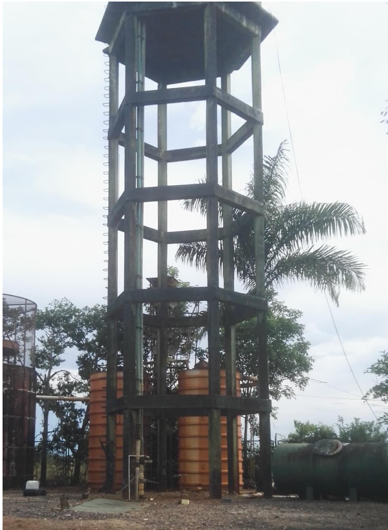
Figura 13. Tanque de Almacenamiento.
