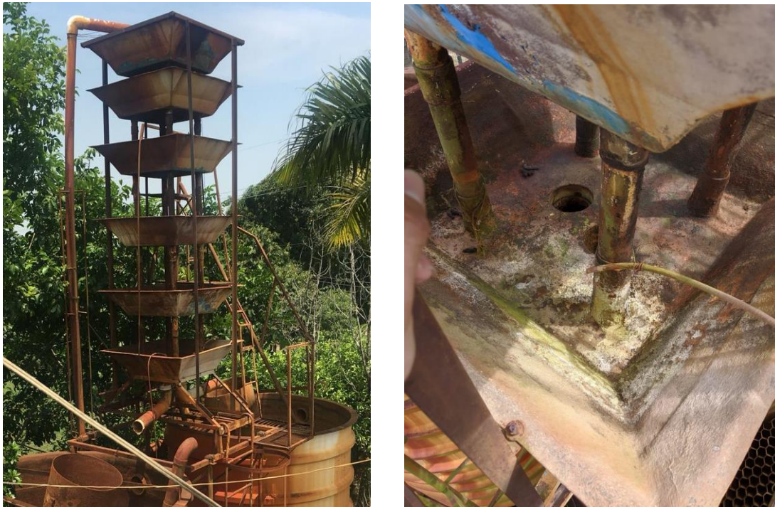
Figura 8. Torre de Aireación.
