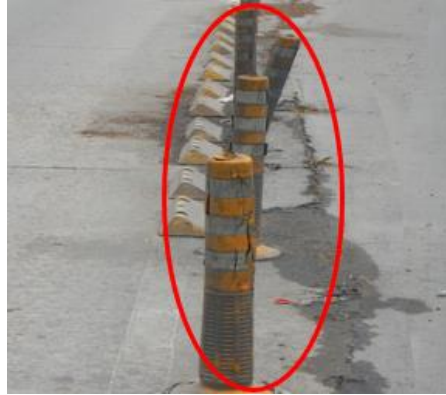
Imagen 68. Deterioro de los delineadores en la Carrera 103 sentido Oriente - Occidente
