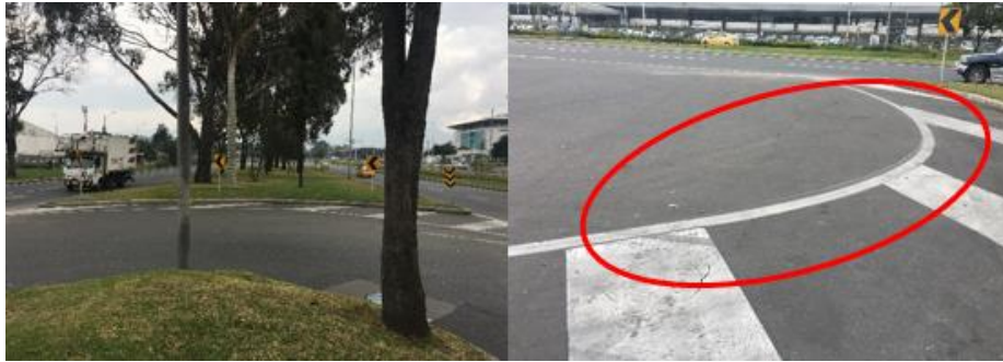
Imagen 82. Retorno sin delineadores de piso en la zona del Puente Aéreo sentido Oriente - Occidente
