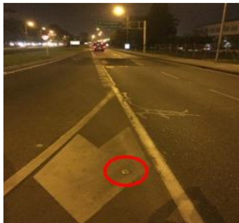
Imagen 75. Anomalías en espaciamiento por tachas en la Carrera 103 sentido Oriente – Occidente
