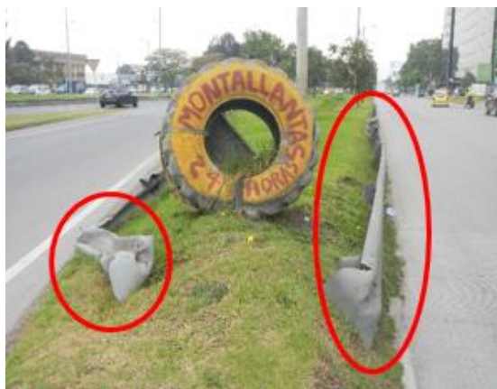
Imagen 52. Carencia de marcador doble de obstáculo en el tramo comprendido entre la Carrera 96A y 96J sentido Oriente - Occidente
