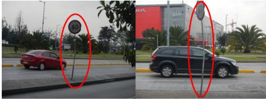
Imagen 39. Deterioro de la señal reglamentaria de velocidad máxima en el sentido Oriente – Occidente de la Transversal 93
