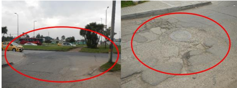
Imagen 45. Superficie de rodamiento en mal estado del tramo vial de la Avenida El Dorado Sentido Oriente – Occidente.
