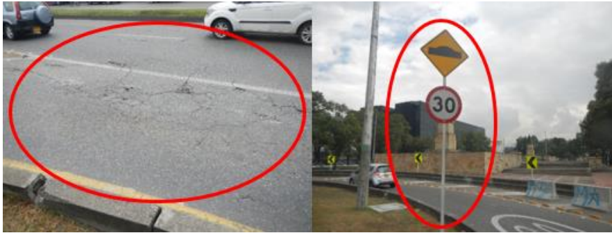
Imagen 60. Estado del pavimento en el retorno vial de la Carrera 100 sentido Occidente - Oriente
