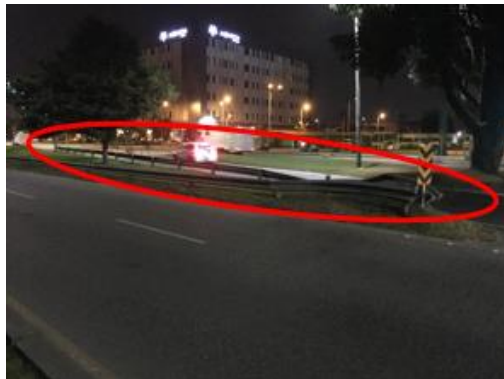
Imagen 67. Carencia de captafaros y delineadores de piso en la Carrera 100Bis sentido Oriente - Occidente
