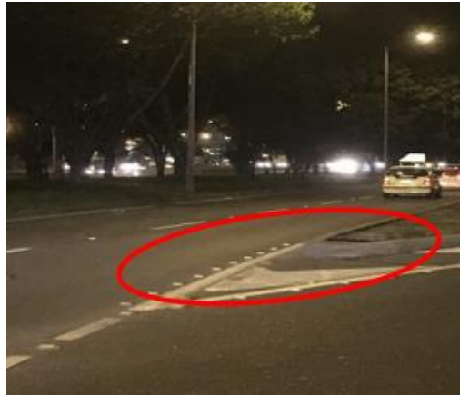
Imagen 74. Deterioro de delineadores de piso en la Carrera 103 sentido Oriente - Occidente
