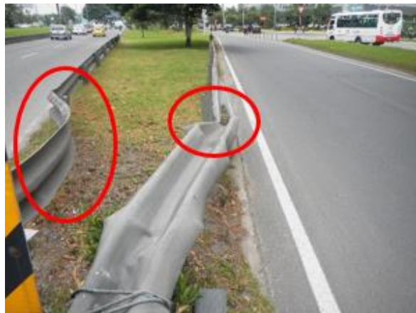
Imagen 65. Deformación de las barreras de contención en la Carrera 100Bis sentido Oriente - Occidente
