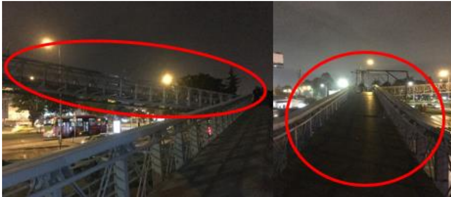
Imagen 72. Carencia de postes de luz en el puente peatonal de la Carrera 103 sentido Oriente - Occidente
