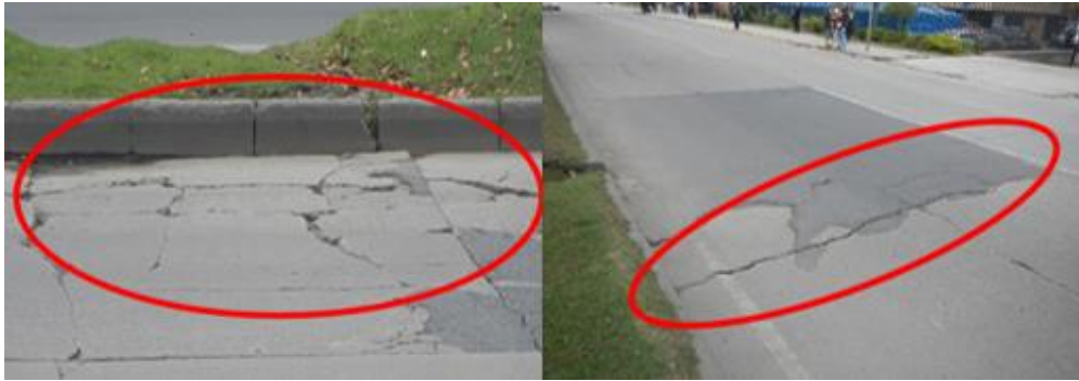
Imagen 64. Estado de la rodadura de pavimento en la Carrera 100Bis sentido Oriente - Occidente
