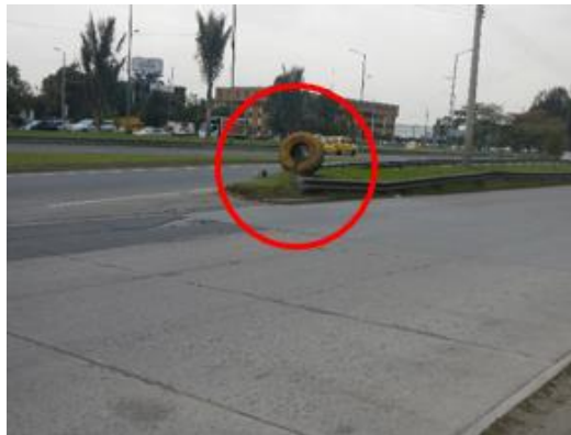
Imagen 51. Deterioro de las barreras de contención en el tramo comprendido entre la Carrera 96A y 96J sentido Oriente – Occidente
