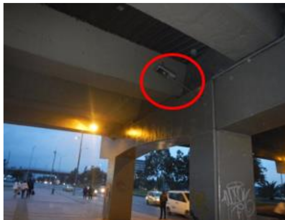
Imagen 26. Iluminación deficiente debajo del puente de la Avenida Carrera 86.
