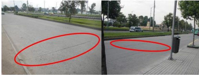
Imagen 54. Grietas longitudinales en la superficie de rodadura entre la Carrera 96J y 100 sentido Oriente – Occidente.
