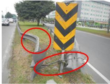
Imagen 66. Barreras de contención amarradas al marcador doble en la Carrera 100Bis sentido Oriente - Occidente
