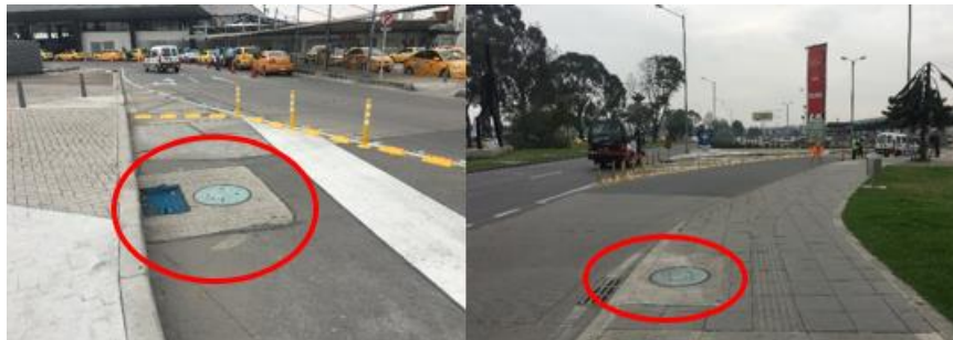
Imagen 81. Obstrucción de sumideros en la zona del Puente Aéreo sentido Oriente - Occidente
