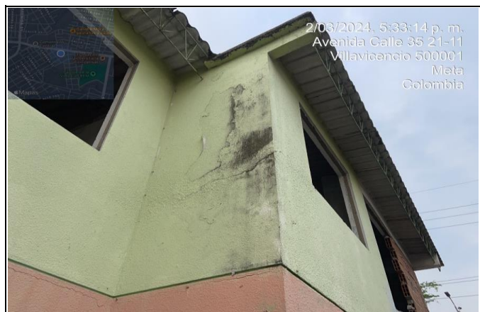
Locales los cuales no cuentan con ventanas y genera el ingreso de agua lluvia
