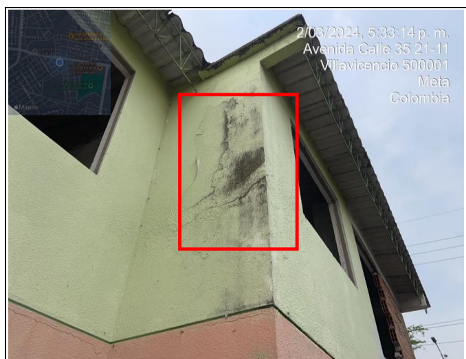
Fisura en fachada local No 1
