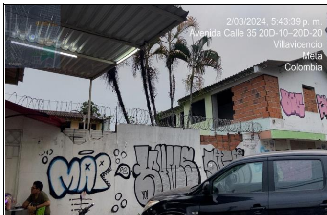
Locales los cuales no cuentan con ventanas y genera el ingreso de agua lluvia
