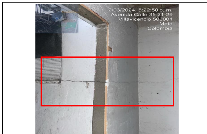
Fisura en columna del local No 3 la cual se presenta en columna y ya estan muro de mamposteria
