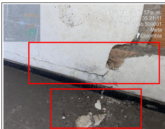
Fisura o grieta con desprendimiento de reboque o pañete en local No 2
