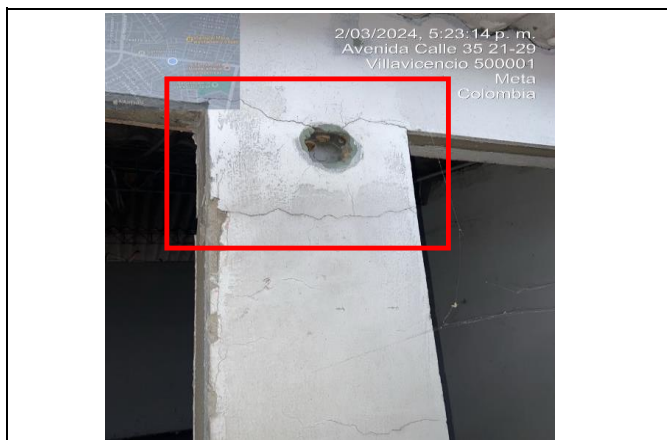
fisura en muro de mamposteria de confinamiento para ventana y puerta local No 3
