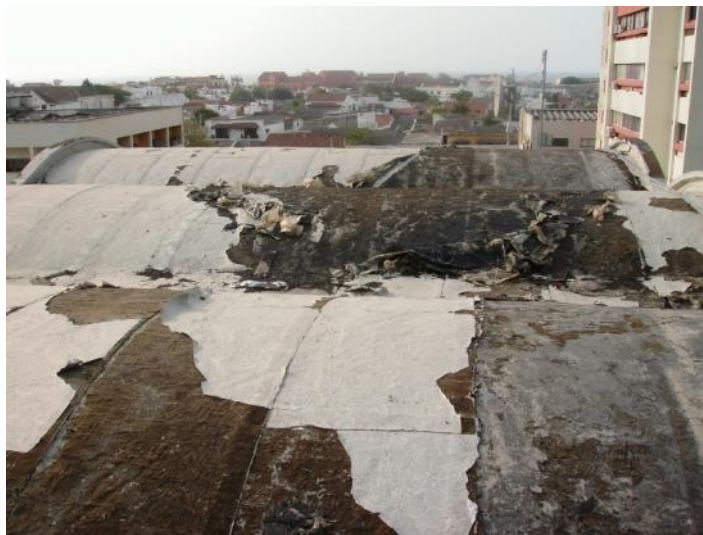
Imagen 12: Desprendimiento del manto Impermeable de la cubierta
