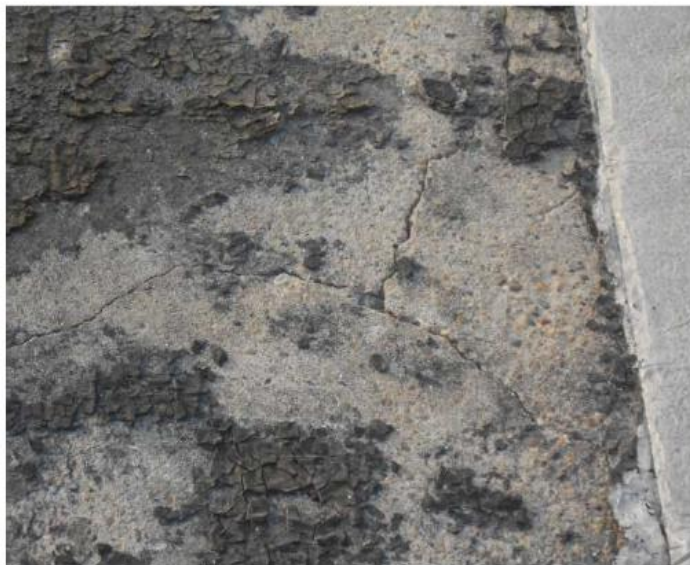
Imagen 13: Fisuras de la Cubierta Abovedada
