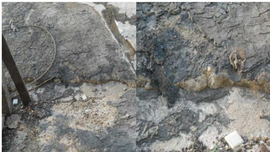
Imagen 17: Desprendimiento de la capa impermeabilizante de la cubierta Pérdida de masa en algunas zonas donde se ha perdido el manto impermeable y eventualmente la capa de mortero sobre la cubierta.
