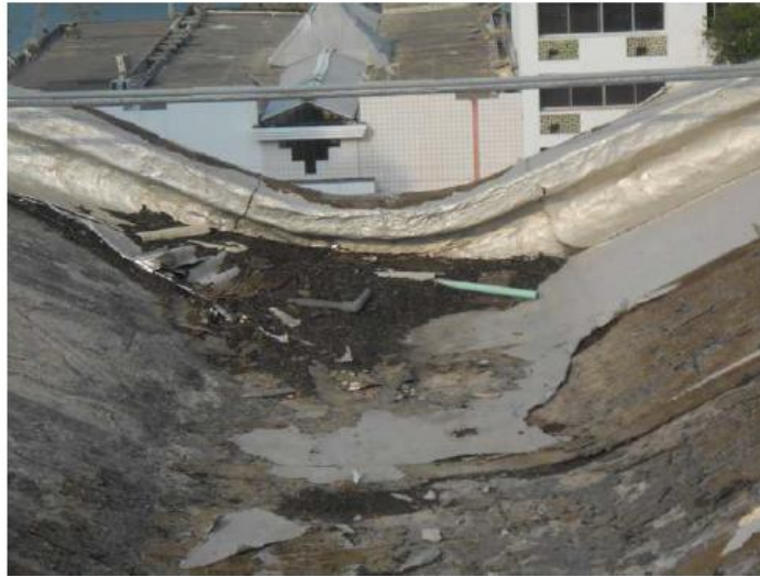
Imagen 15: Taponamiento del sistema de desagüe
