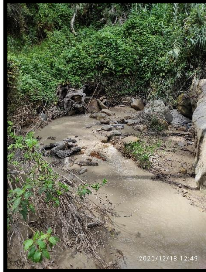
Imagen N°5. Arrastre de escombros y material vegetal cerca a la Bocatoma.
