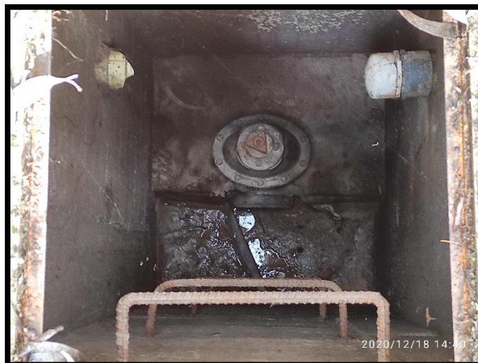
Imagen N°18. Caja de Válvula de Lavado.
