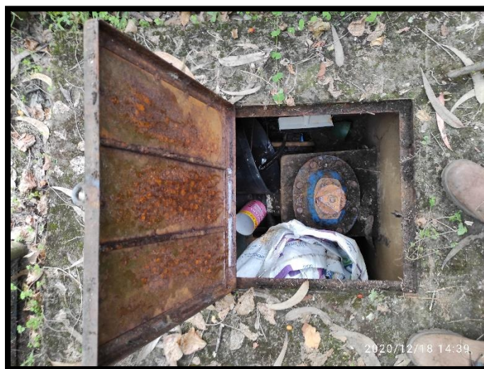
Imagen N°19. Caja de Válvula de Salida.
