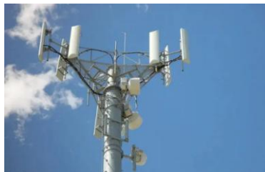
Figura N° 1 Torre de Telecomunicaciones con Antenas para redes inalámbricas [16]
