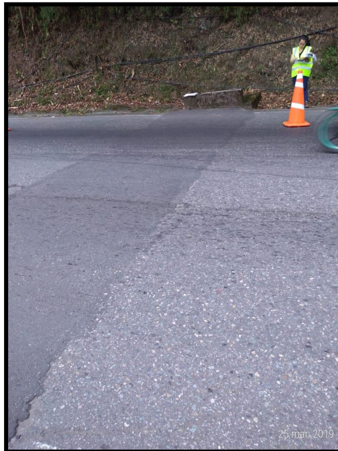
Figura 11-5 Parche (PCH). Fuente: Propia, 2019.
