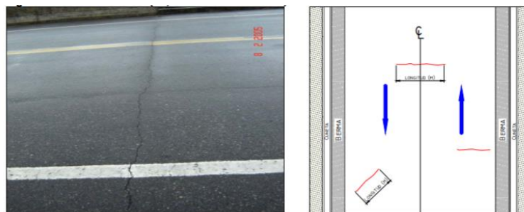
Figura 6-3 Fisura longitudinal en junta de construcción (FCL, Unidad de medida: m). Fuente: [2].
