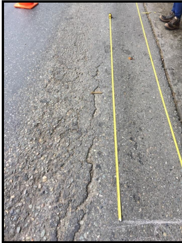
Figura 11-6 Fisura Longitudinal (FL). Fuente: Propia, 2019.
