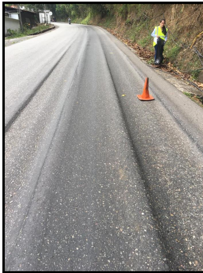
Figura 11-1 Ahuellamiento (AHU). Fuente: Propia, 2019.
