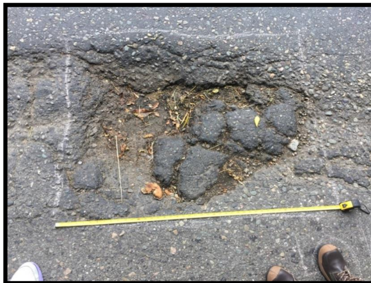
Figura 11-4 Bache (BCH). Fuente: Propia, 2019.
