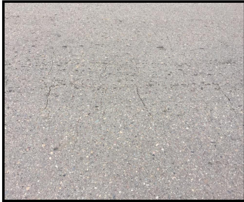
Figura 11-7 Fisura Transversal (FT).
