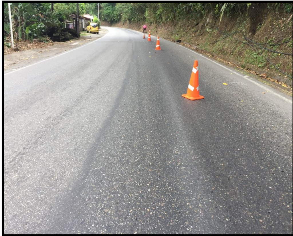
Figura 11-2 Desgaste superficial (DSU).
