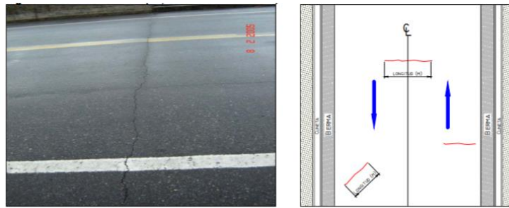
Figura 6-2 Fisuras transversales (FT, Unidad de medida: m). Fuente: [2].
