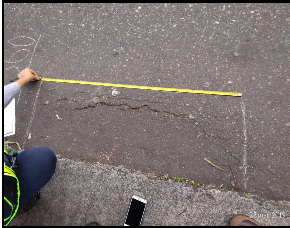
Figura 11-10 Fisura de Medialuna (FML).
