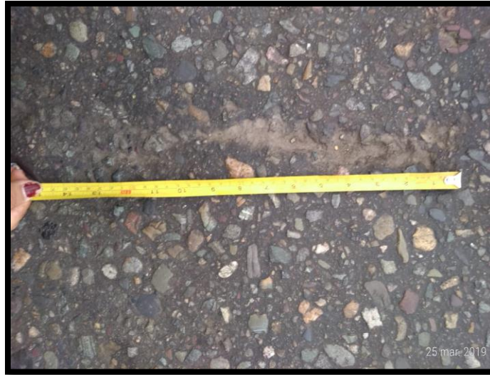
Figura 11-12 Perdida del Agregado (PA). Fuente: Propia, 2019.
