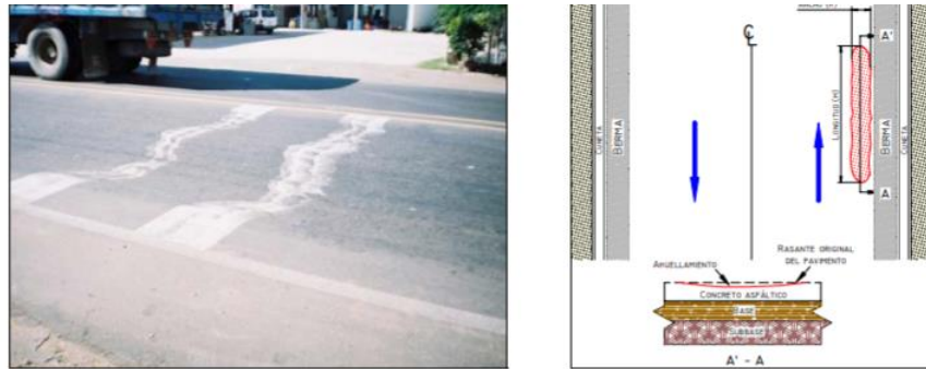
Figura 6-12 Ahuellamiento (AHU, Unidad de medida: m2). Fuente: [2].
