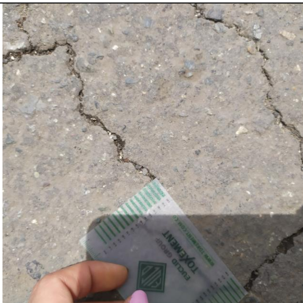
Foto N° 31. Acercamiento a fisuras piel de cocodrilo encontrado en el tramo K0+0300 – K0+0400. Sentido Coello -Espinal.
