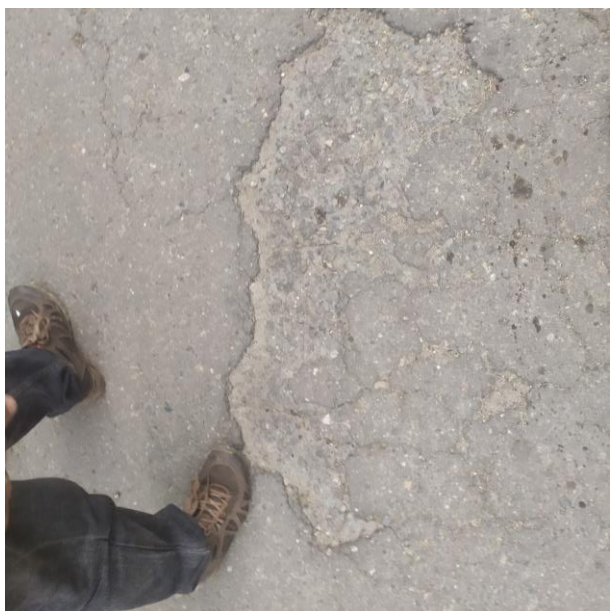
Foto N° 19. Descascaramiento del pavimento encontrado en el tramo K0+0100 – K0+0200. Sentido Coello -Espinal.
