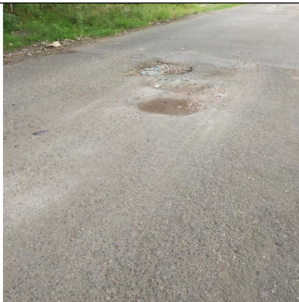
Foto N° 36. Ojo de pescado encontrado en el tramo K0+0300 – K0+0400. Sentido Espinal-Coello.
