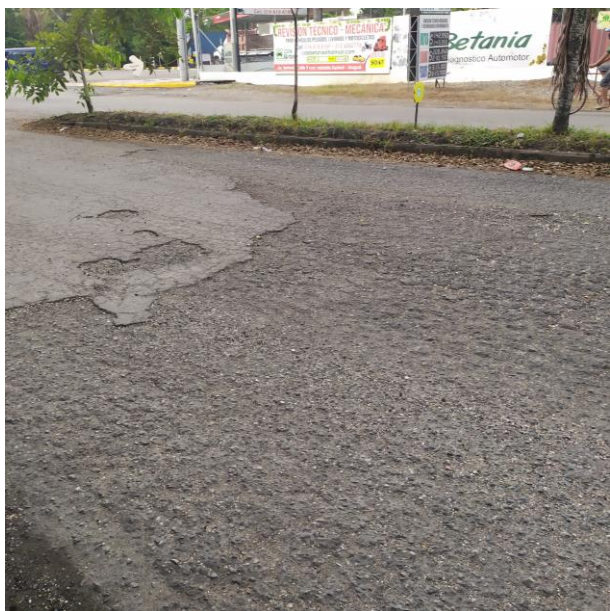
Foto N° 11. Descascaramiento con nivel de severidad alto, encontrado en el tramo K0+0100 – K0+0200. Sentido Coello -Espinal.
