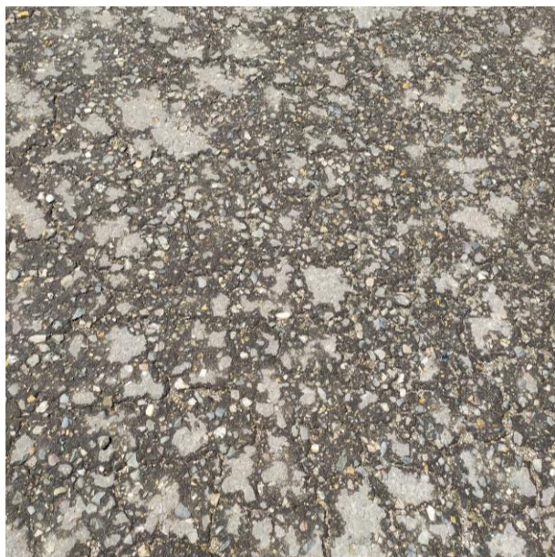
Foto N° 46. Perdida de ligante encontrado en el tramo K0+0500 – K0+0600. Sentido Espinal-Coello.
