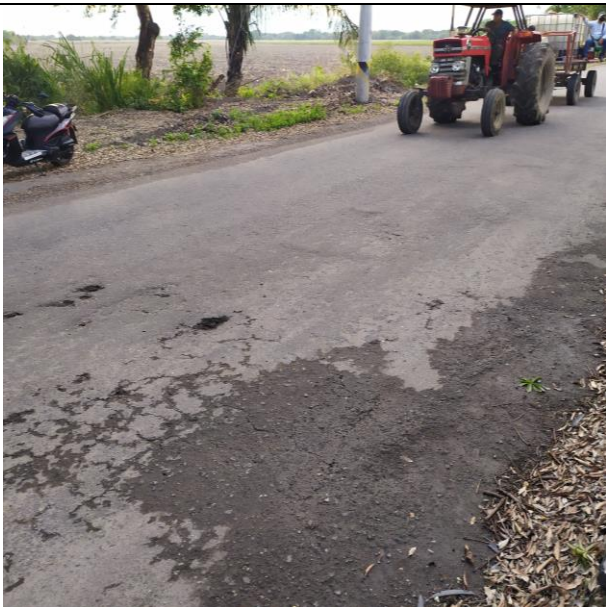
Foto N° 39. Fisuras piel de cocodrilo junto con pérdida de material de liga en secciones del pavimento encontrado en el tramo K0+0400 – K0+0500. Sentido Coello -Espinal.
