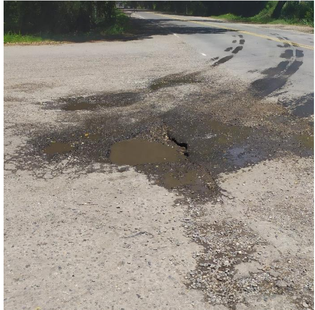
Foto N° 2. Ojos de pescado con nivel de severidad Alto, encontrado en el tramo K0+000 – K0+0100. Sentido Espinal – Coello.
