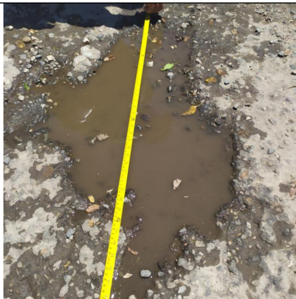
Foto N° 10. Descascaramiento con nivel de severidad alto, encontrado en el tramo K0+000 – K0+0100. Sentido Espinal – Coello.
