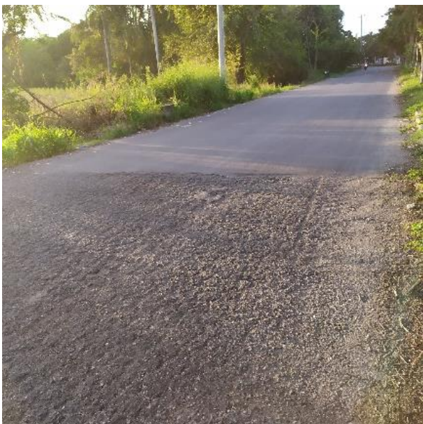
Foto N° 23. Perdida de agregado junto a tramo con reconstrucción de pavimento encontrado en el tramo K0+0200 – K0+0300. Sentido Coello -Espinal.
