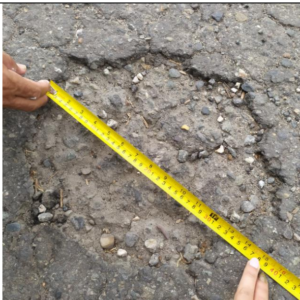
Foto N° 9. Descascaramiento con nivel de severidad medio, encontrado en el tramo K0+000 – K0+0100. Sentido Coello -Espinal.
