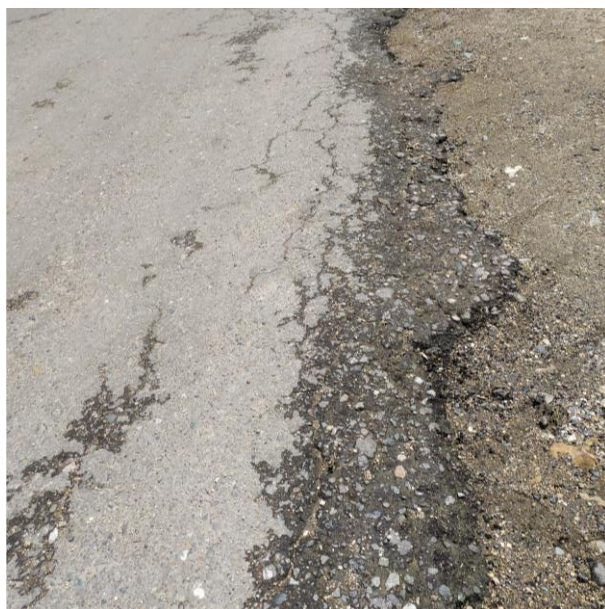
Foto N° 58. Desintegración del borde de la vía, encontrado en el tramo K0+0700 – K0+0800. Sentido Espinal- Coello.
