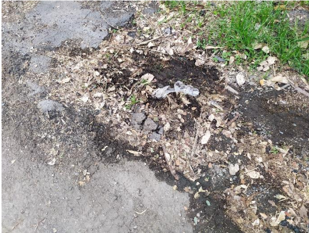
Foto N° 3. Desprendimiento de Borde de la vía con nivel de severidad medio encontrado en el tramo K0+000 – K0+0100. Sentido Coello - Espinal
