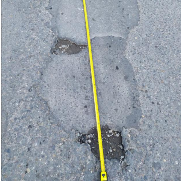
Foto N° 59. Formación de ojo de pescado en áreas contiguas a los Baches, encontrado en el tramo K0+0700 – K0+0800. Sentido Coello - Espinal.
