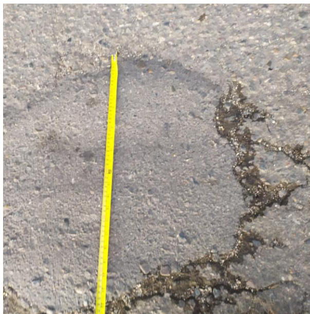
Foto N° 42. Acercamiento a bache para observa la perdida de agregado, encontrado en el tramo K0+0400 – K0+0500. Sentido Espinal- Coello.
