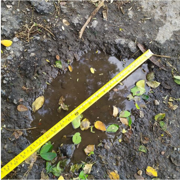
Foto N° 1. Descascaramiento con nivel de severidad medio, encontrado en el tramo K0+000 – K0+0100. Sentido Coello -Espinal.
