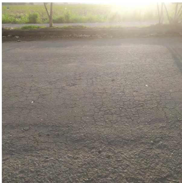
Foto N° 38. Fisuras piel de cocodrilo encontrado en el tramo K0+0400 – K0+0500. Sentido Espinal- Coello.
