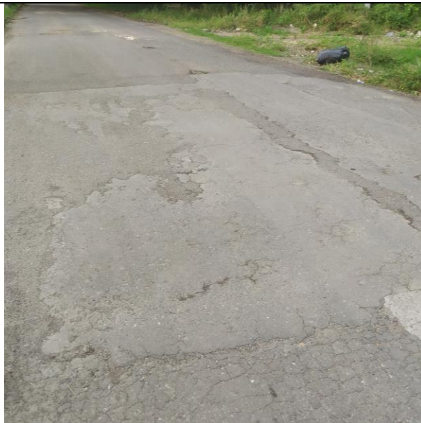
Foto N° 30. Descascaramiento de pavimento encontrado en el tramo K0+0200 – K0+0300. Sentido Espinal - Coello
