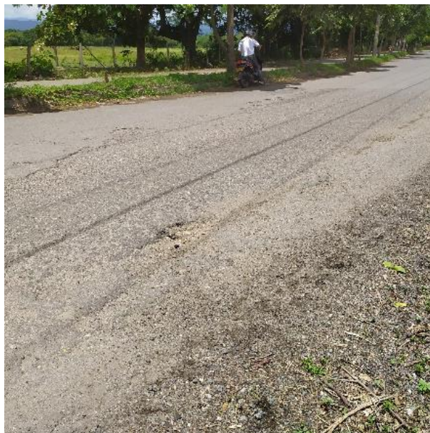
Foto N° 24. Perdida de agregado encontrado en el tramo K0+0200 – K0+0300. Sentido Espinal- Coello.
