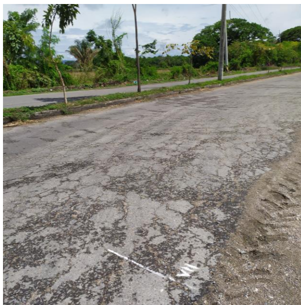
Foto N° 54. Fisuras piel de cocodrilo con pérdida de ligante con un alto estado de deterioro del pavimento, encontrado en el tramo K0+0700 – K0+0800. Sentido Espinal- Coello.
