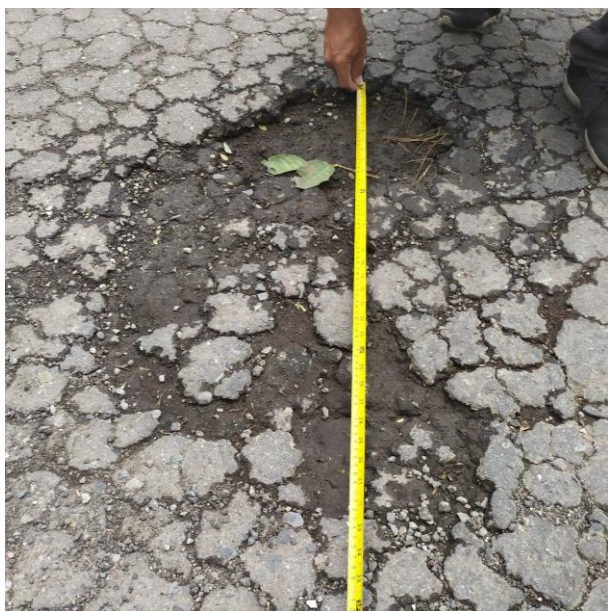
Foto N° 33. Fisuras piel de cocodrilo y formación de ojos de pescado como evolución de FPC encontrado en el tramo K0+0300 – K0+0400. Sentido Coello -Espinal.
