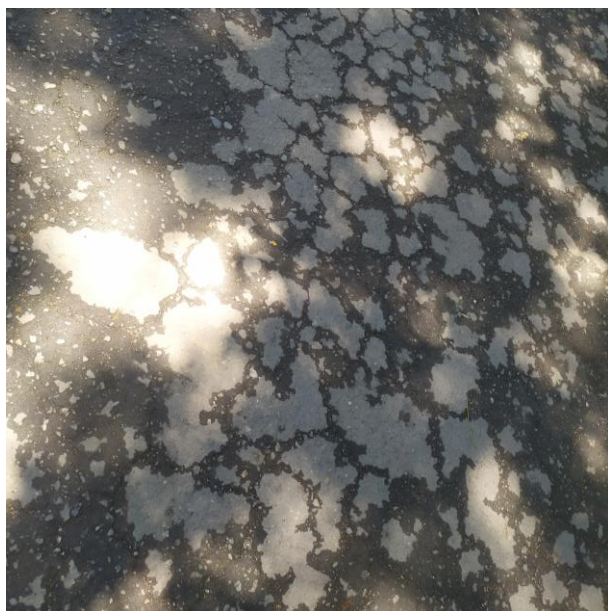
Foto N° 16. Fisuras piel de cocodrilo con nivel de severidad alto, encontrado en el tramo K0+0100 – K0+0200. Sentido Espinal – Coello.
