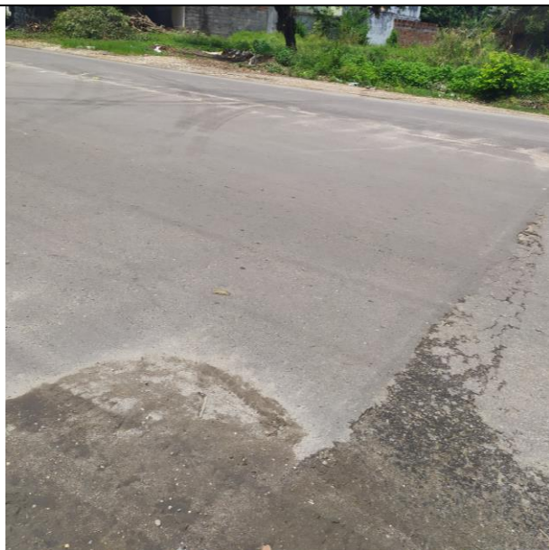
Foto N° 64. Intersección de pavimento deteriorado con el pavimento intervenido, encontrado en el tramo K0+0800 – K0+0840. Sentido Espinal- Coello.
