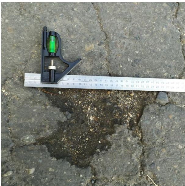
Foto N° 41. Inicios de descascaramiento como evolución de FPC del pavimento encontrado en el tramo K0+0400 – K0+0500. Sentido Coello - Espinal.
