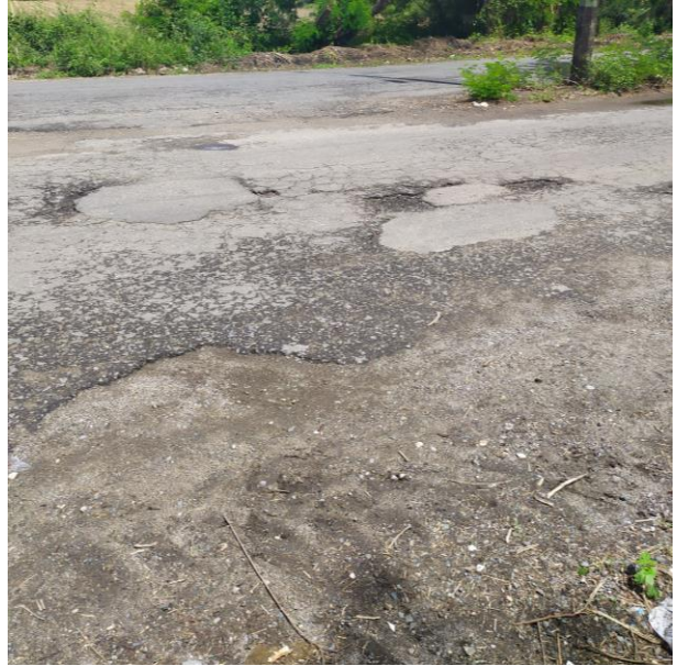
Foto N° 60. Desintegración del borde de la vía junto con fisuras piel de cocodrilo y baches de intervenciones anteriores, encontrado en el tramo K0+0700 – K0+0800. Sentido Espinal-Coello.
