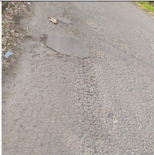
Foto N° 40. Se observan fisuras piel de cocodrilo junto con Baches con perdida de agregado en su alrededor, encontrado en el tramo K0+0400 – K0+0500. Sentido Espinal- Coello.
