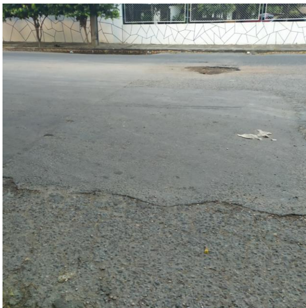
Foto N° 65. Desintegración del borde de la vía en pavimento, encontrado en el tramo K0+0800 – K0+0840. Sentido Coello -Espinal.
