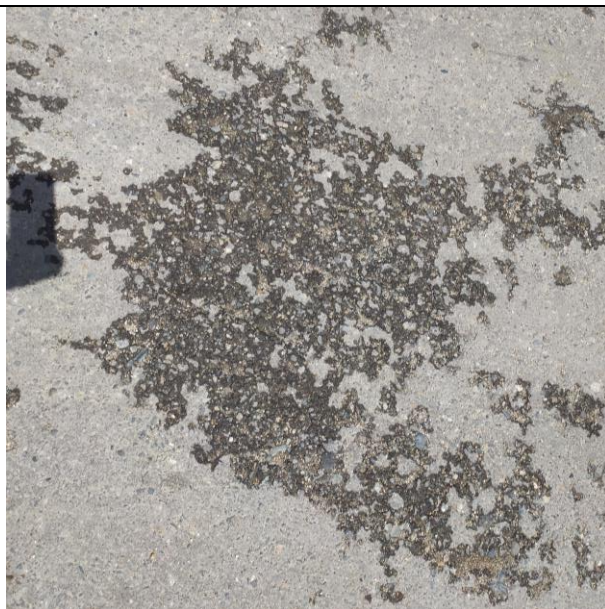
Foto N° 56. Pérdida de ligante localizada, encontrado en el tramo K0+0700 – K0+0800. Sentido Espinal- Coello.
