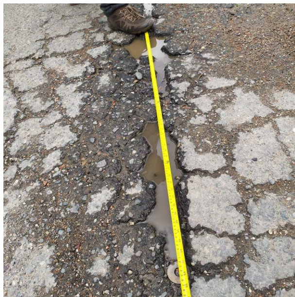
Foto N° 66. Fisuras piel de cocodrilo con descascaramientos y pedida de ligante, encontrado en el tramo K0+0800 – K0+0840. Sentido Espinal- Coello.
