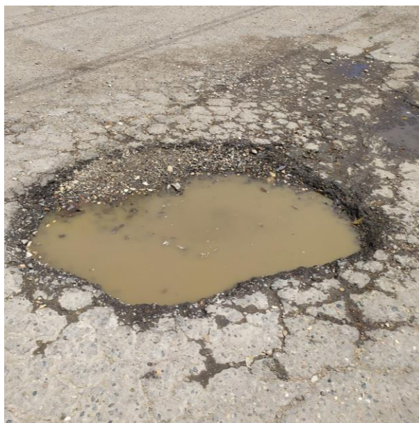
Foto N° 8. Ojo de pescado con nivel de severidad alto, encontrado en el tramo K0+000 – K0+0100. Sentido Espinal – Coello.
