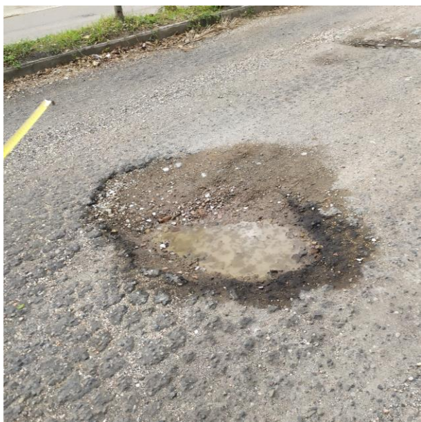
Foto N° 15. Ojo de pescado con nivel de severidad alto, encontrado en el tramo K0+0100 – K0+0200. Sentido Coello -Espinal.
