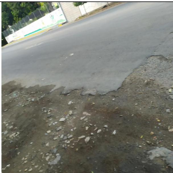
Foto N° 63. Desintegración del borde de la vía en pavimento, encontrado en el tramo K0+0800 – K0+0840. Sentido Coello -Espinal.
