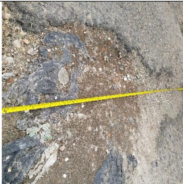
Foto N° 26. Ojo de pescado con alto grado de severidad encontrado en el tramo K0+0200 – K0+0300. Sentido Espinal- Coello..
