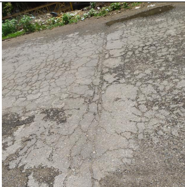
Foto N° 52. Fisuras piel de cocodrilo con pérdida de ligante, encontrado en el tramo K0+0600 – K0+0700. Sentido Espinal- Coello.
