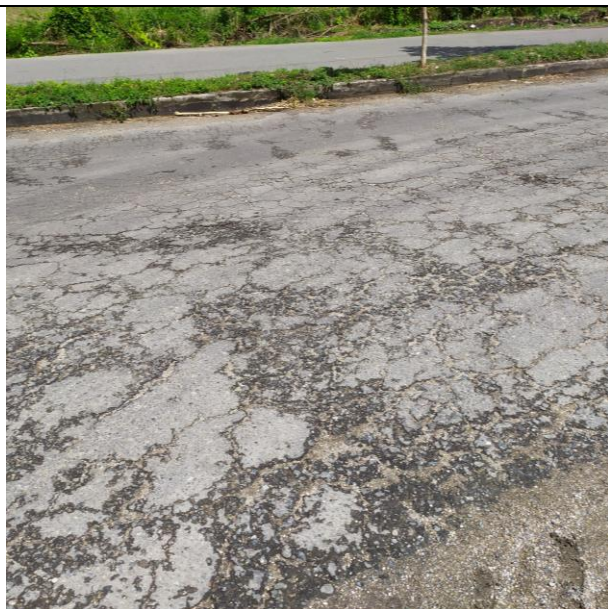
Foto N° 44. Fisuras piel de cocodrilo acompañadas de perdida de ligante encontrado en el tramo K0+0500 – K0+0600. Sentido Espinal-Coello.
