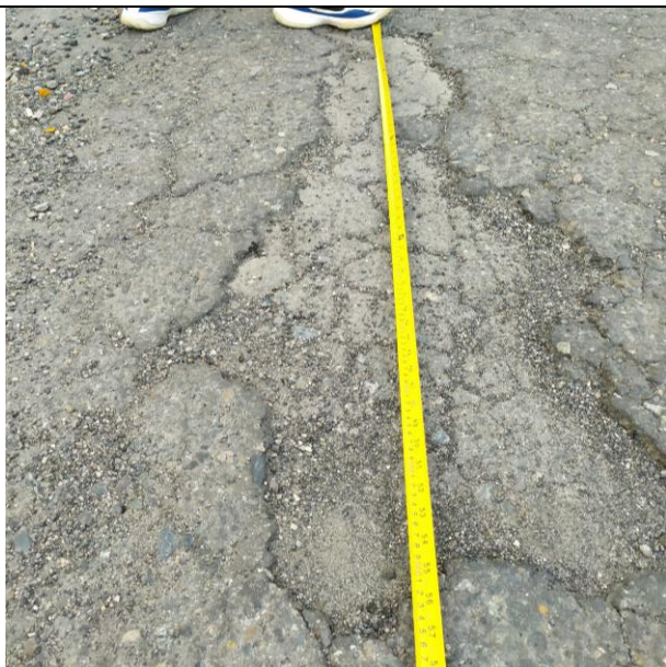
Foto N° 47. Descascaramiento del pavimento (sobre Carpeta) encontrado en el tramo K0+0500 – K0+0600. Sentido Coello -Espinal.
