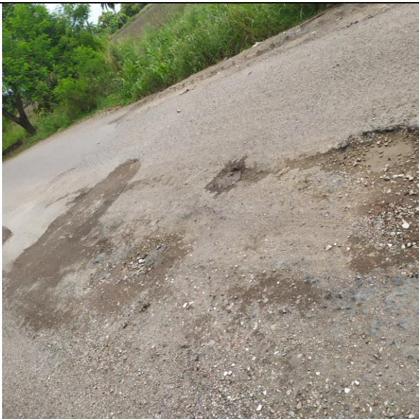
Foto N° 29. Ojos de pescado y pérdida de agregado encontrado en el tramo K0+0200 – K0+0300. Sentido Coello -Espinal.
