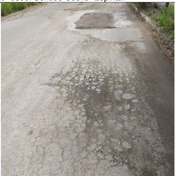
Foto N° 29. Fisuras piel de cocodrilo con inicios de pérdida de agregado encontrado en el tramo K0+0300 – K0+0400. Sentido Coello -Espinal.
