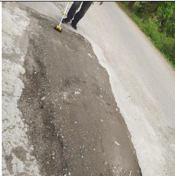
Foto N° 22. Desintegración de la capa de rodadura encontrado en el tramo K0+0200 – K0+0300. Sentido Espinal- Coello.
