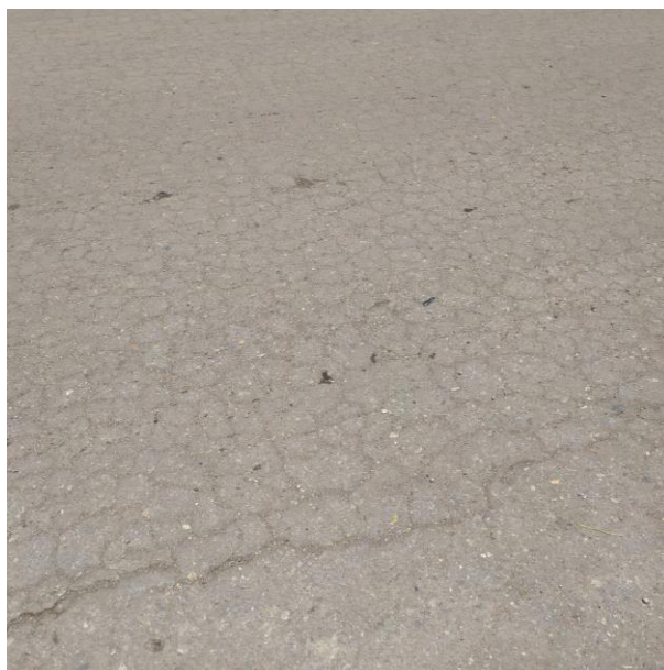
Foto N° 8. Fisuras piel de cocodrilo con nivel de severidad medio, encontrado en el tramo K0+000 – K0+0100. Sentido Espinal – Coello
