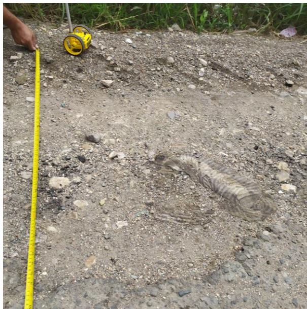
Foto N° 28. Desintegración del borde del pavimento encontrado en el tramo K0+0200 – K0+0300. Sentido Espinal- Coello.
