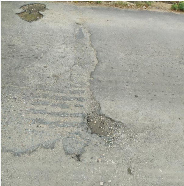
Foto N° 61. Formación de ojo de pescado, fisura transversal, encontrado en el tramo K0+0700 – K0+0800. Sentido Coello -Espinal.
