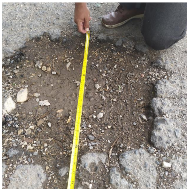
Foto N° 34. Ojo de pescado encontrado en el tramo K0+0300 – K0+0400. Sentido Espinal- Coello.
