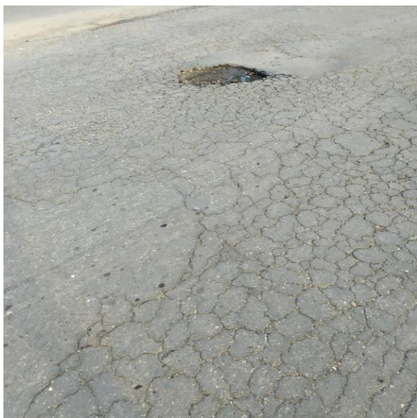
Foto N° 49. Fisuras piel de cocodrilo con ojo de pescado junto a un Bache, encontrado en el tramo K0+0600 – K0+0700. Sentido Coello - Espinal.
