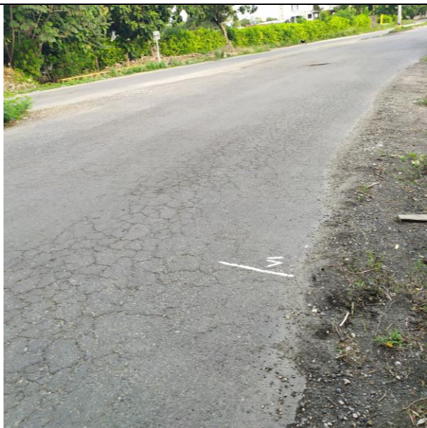
Foto N° 43. Fisuras piel de cocodrilo encontrado en el tramo K0+0500 – K0+0600. Sentido Coello - Espinal.
