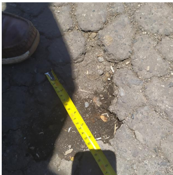
Foto N° 20. Desprendimiento del pavimento como evolución de fisuras piel de cocodrilo, encontrado en el tramo K0+0100 – K0+0200. Sentido Espinal – Coello.
