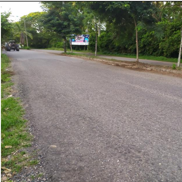
Foto N° 21. Perdida de agregado encontrado en el tramo K0+0200 – K0+0300. Sentido Coello - Espinal.
