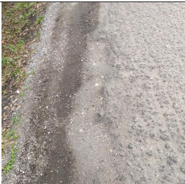
Foto N° 13. Desprendimiento de borde con nivel de severidad alto, encontrado en el tramo K0+0100 – K0+0200. Sentido Coello -Espinal.
