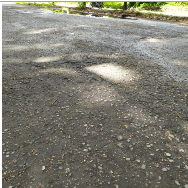
Foto N° 48. Perdida de ligante encontrado en el tramo K0+0500 – K0+0600. Sentido Espinal-Coello.
