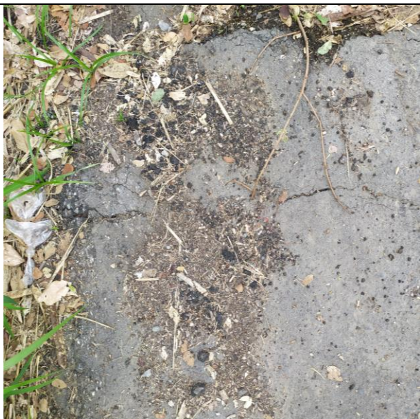
Foto N° 5. Fisura transversal con nivel de severidad bajo, encontrado en el tramo K0+000 – K0+0100. Sentido Coello -Espinal
