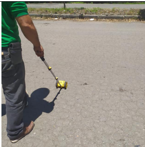
Foto N° 10. Fisuras piel de cocodrilo con nivel de severidad medio, encontrado en el tramo K0+000 – K0+0100. Sentido Espinal – Coello
