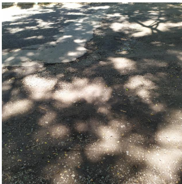
Foto N° 12. Perdida de agregado con nivel de severidad alto, con evolución a pérdida de capa de rodadura, encontrado en el tramo K0+0100 – K0+0200. Sentido Espinal – Coello.
