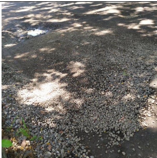
Foto N° 14. Perdida de capa de rodadura, encontrado en el tramo K0+0100 – K0+0200. Sentido Espinal – Coello.
