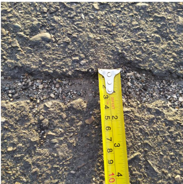
Foto N° 27. Erosión del pavimento causada por fricción con una profundidad aproximada de 0.5 Cm, encontrado en el tramo K0+0200 – K0+0300. Sentido Coello -Espinal.
