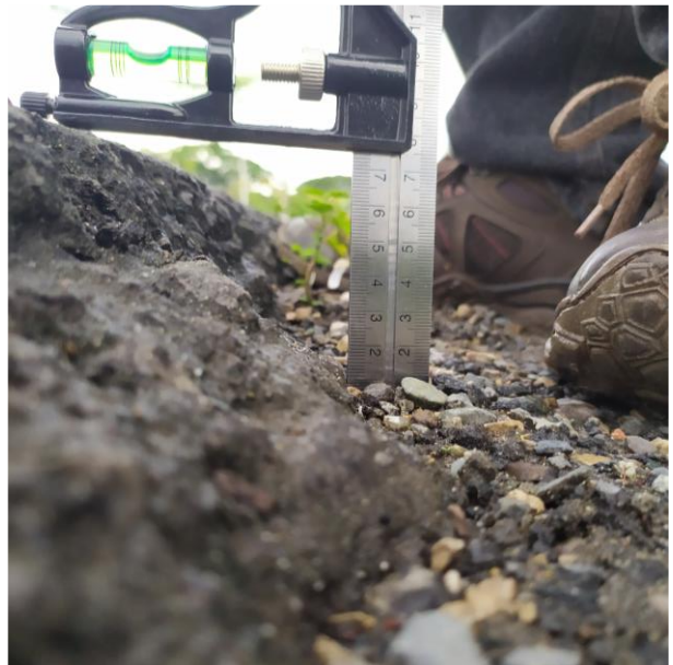
Foto N° 62. Caída en punta del borde del carril, cuya severidad es medida debido a que la diferencia de nivel es de 7.5 Cm aprox, encontrado en el tramo K0+0700 – K0+0800. Sentido Espinal- Coello.
