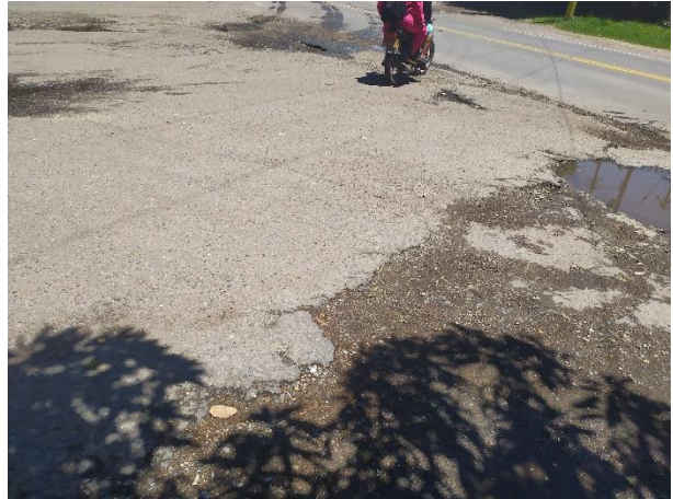
Foto N° 4. Desprendimiento de Borde de la vía con nivel de severidad bajo, encontrado en el tramo K0+000 – K0+0100. Sentido Espinal – Coello.
