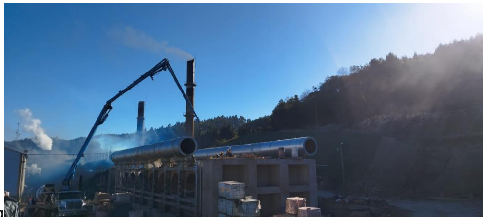
Imagen 10 Fundida placa de recubrimiento sobre cupulas de hornos solera
