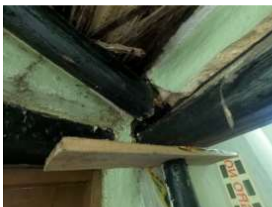
Figura 33. Pudrición de la madera de estructura de cubierta y viga de vano acceso a la cocina. Fuente: Propia
