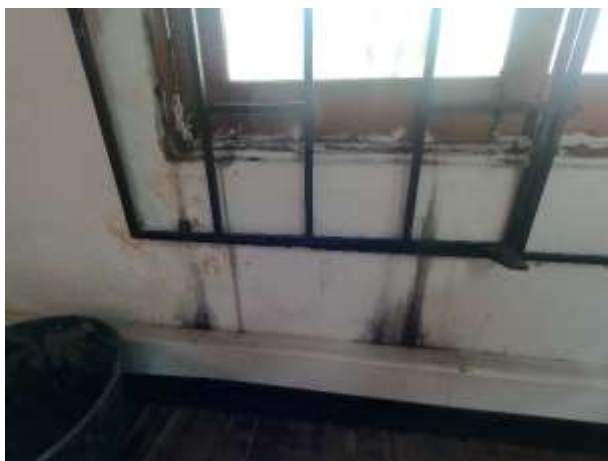
Figura 36. Manchas de humedad por filtración desde la viga canal por insuficiencia de desagüe. Fuente: Propia
