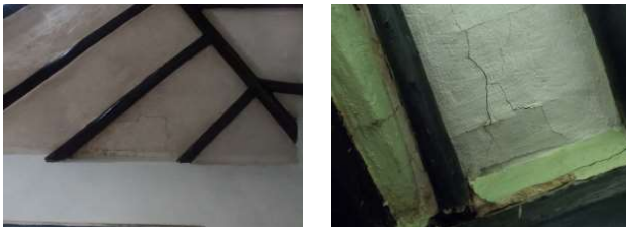
Figura 24 y 25. Fisuras en el recubrimiento del cielo raso. Fuente: Propia
