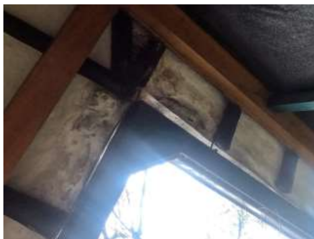
Figura 23. Lesiones de manchas y desprendimientos del cielo raso por humedades por filtración. Fuente: Propia
