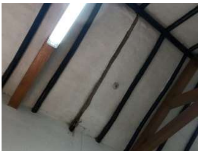
Figura 34. Perdida de elemento estructural en madera de la cubierta sobre fachada principal. Fuente: Propia
