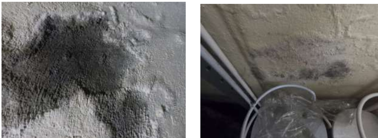
Figura 14 y 15. Lesiones de abombamientos y manchas en los muros. Fuente: Propia
