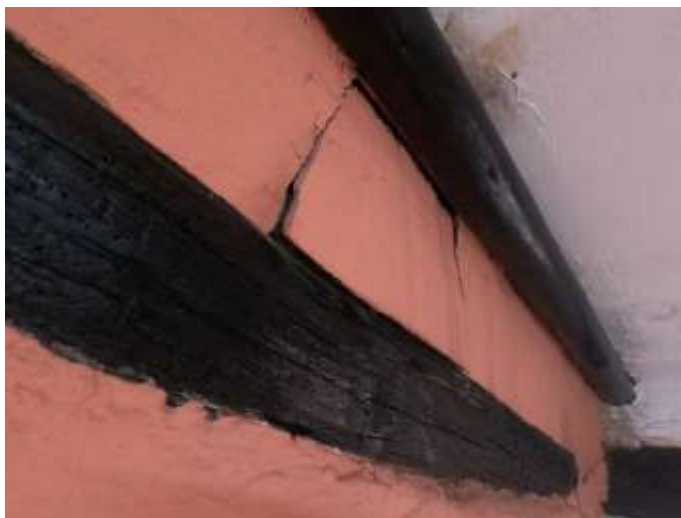
Figura 35. Desprendimiento de material de acabado (pañete) por humedad del muro y de la madera de la cubierta. Fuente: Propia
