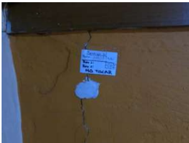
Figura 37. Colocación de testigo frágil en yeso para seguimiento de fisuras y grietas. Fuente: Propia
