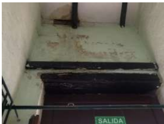
Figura 32. Avance de la pudrición de la viga de madera del vano de acceso principal. Fuente: Propia
