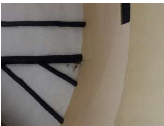
Figura 22. Lesiones de manchas en el cielo raso. Fuente: Propia
