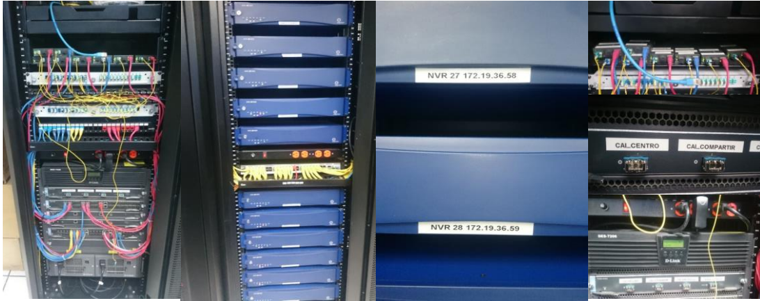
Figura 47. Rack's de administración del sistema
