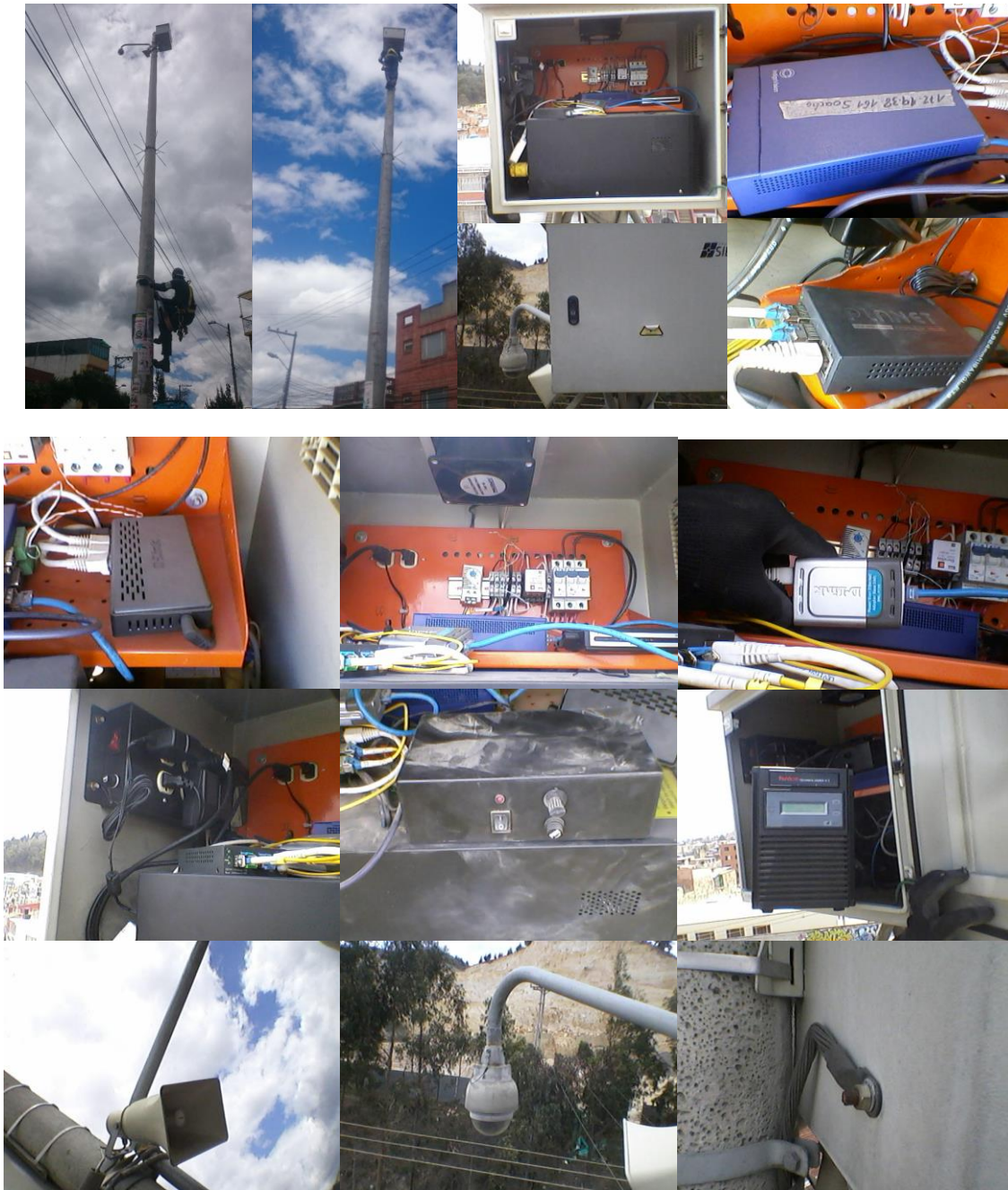
Figura 51. Registro fotográfico de algunos de los gabinetes
