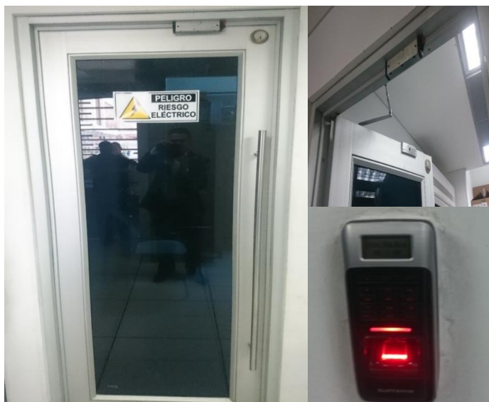
Figura 43. Control de acceso centro de datos
