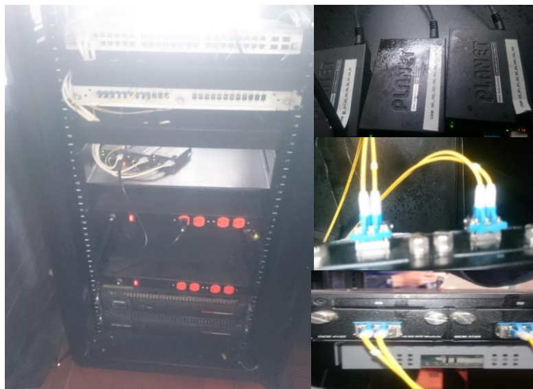
Figura 39. Evidencia rack Nodo San Mateo
