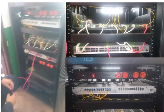
Figura 35. Evidencia rack Nodo Centro Soacha
