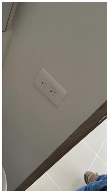
Proyecto Arboleda Campestre 4 Supervisión funcionamiento de puntos eléctricos Fuente: Propia
