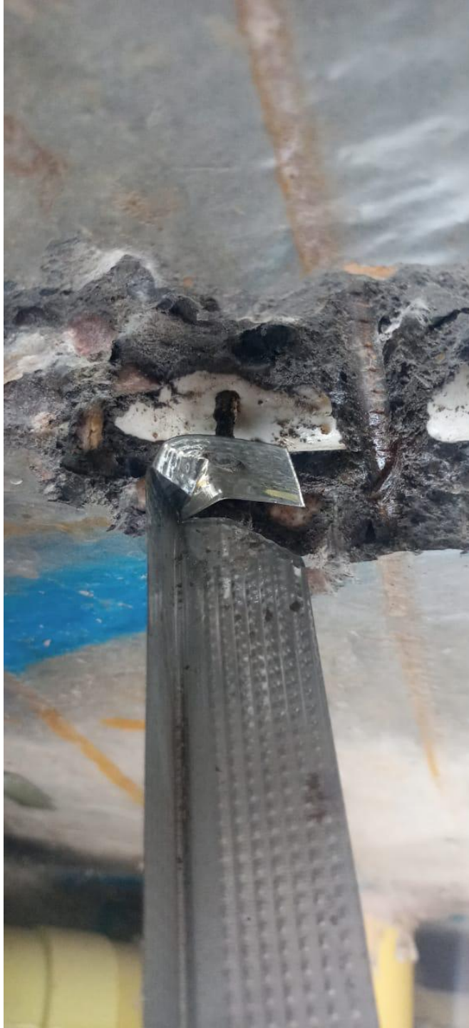
Proyecto Arboleda Campestre 4 Fuga de agua Fuente: Propia
