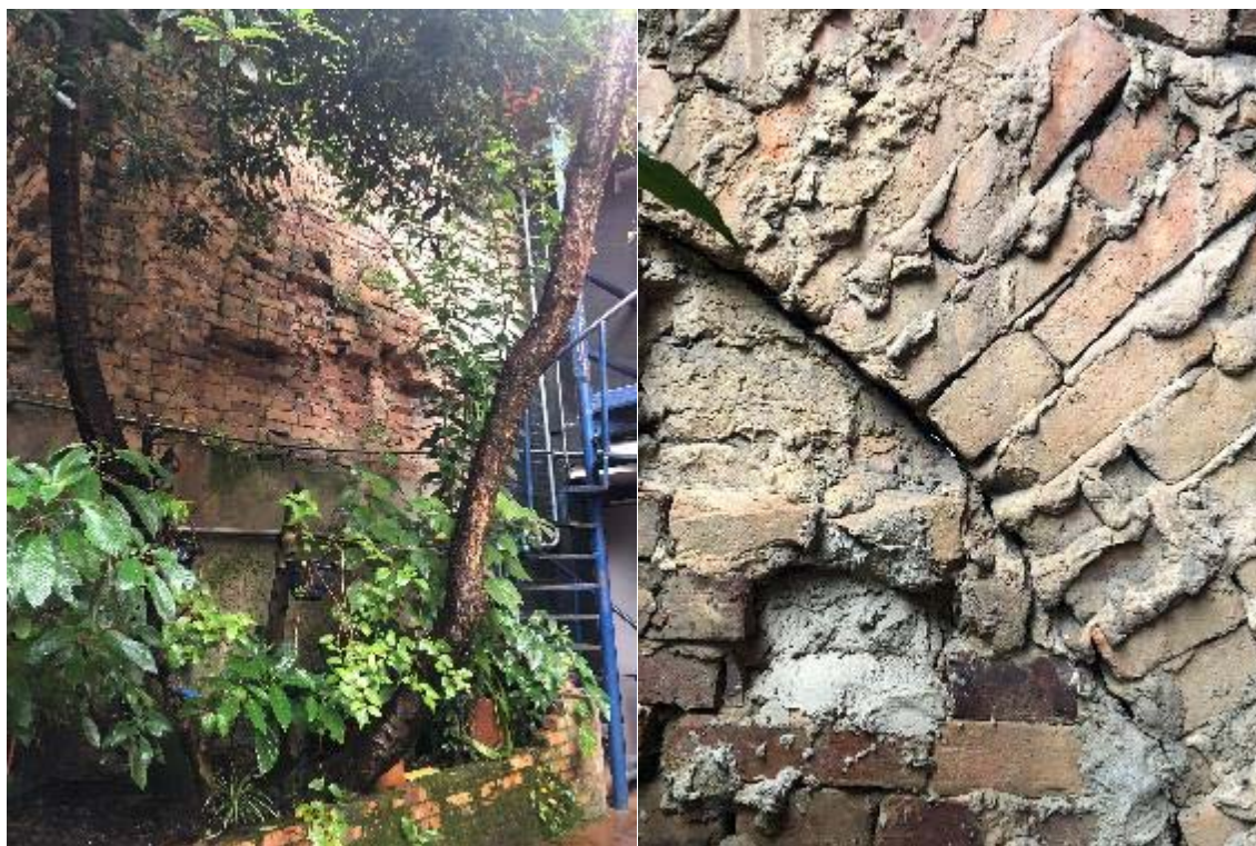
Imagen 10 Costado occidental del muro, irregularidades en mampuestos
