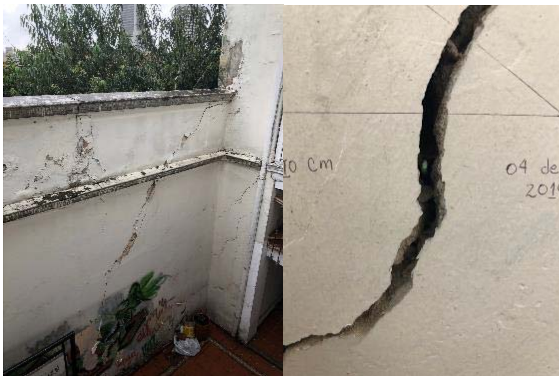
Imagen 8 Muro occidental agrietado.
