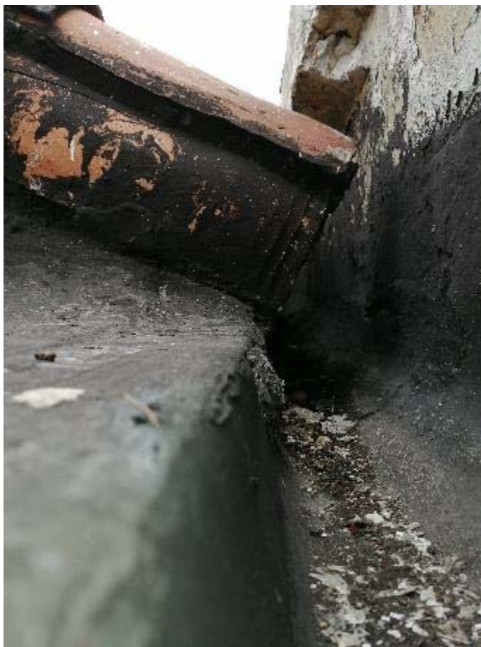
Imagen 6 Canales que permiten filtraciones por inadecuada impermeabilización
