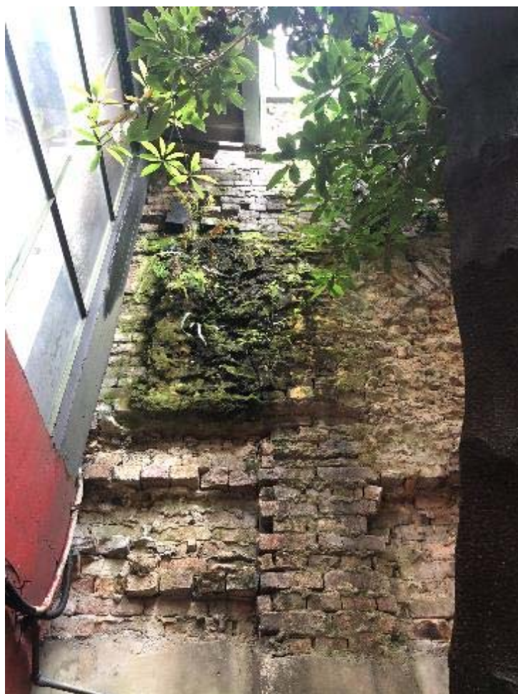
Imagen 4 Humedad Vista desde costado vecino. Fuente propia
