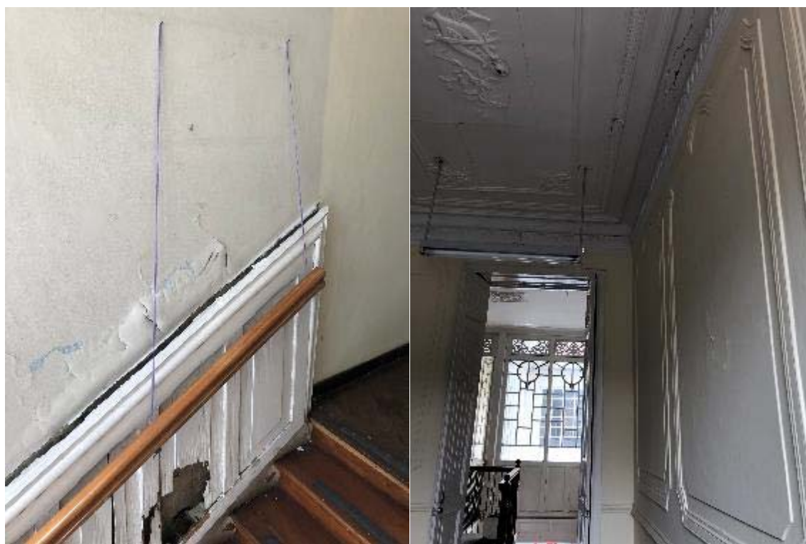
Imagen 11 Desprendimiento elementos de escalera
