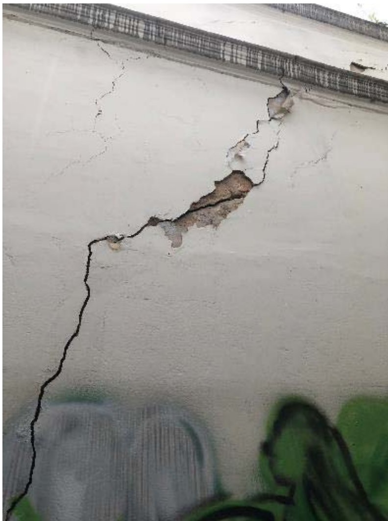
Imagen 24 Grieta general patio central. Fuente propia.
