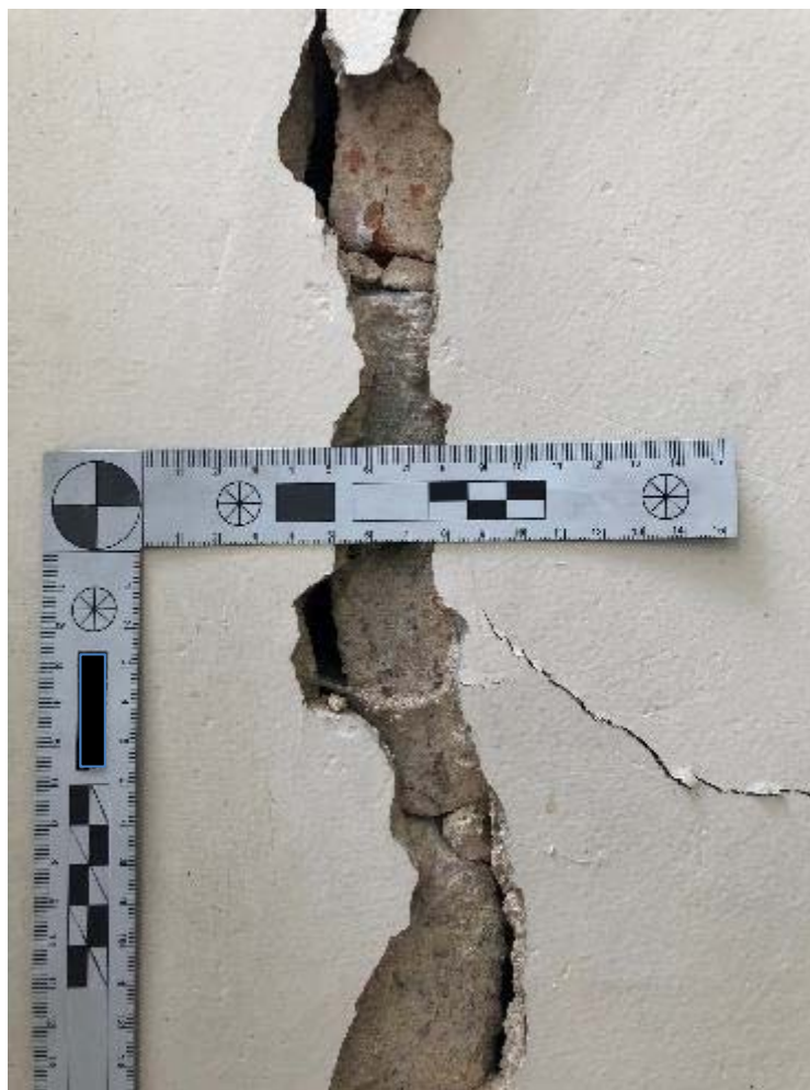
Imagen 22 Grieta tipo. Fuente propia.
