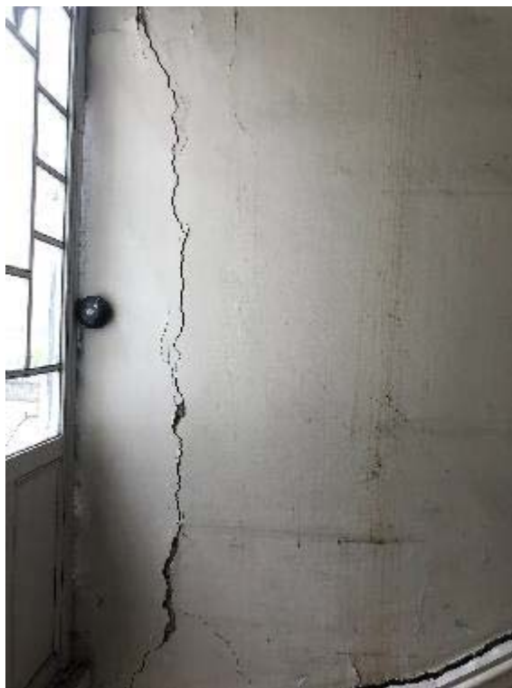
Imagen 12 Grieta de muro zona escalera
