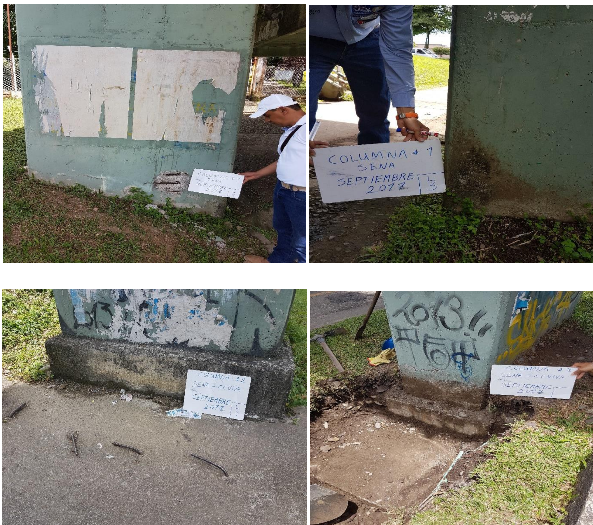
Figura 31. Patologías encontradas en pilas del puente peatonal
