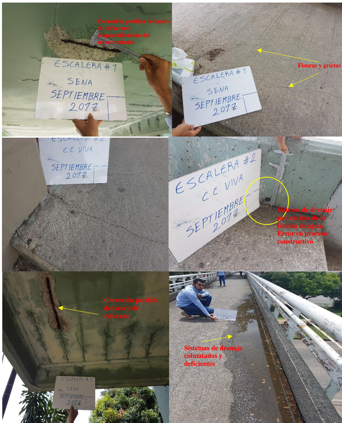
Figura 25. Otras patologías encontradas en la superficie del puente peatonal y accesos Fuente: Los autores.
