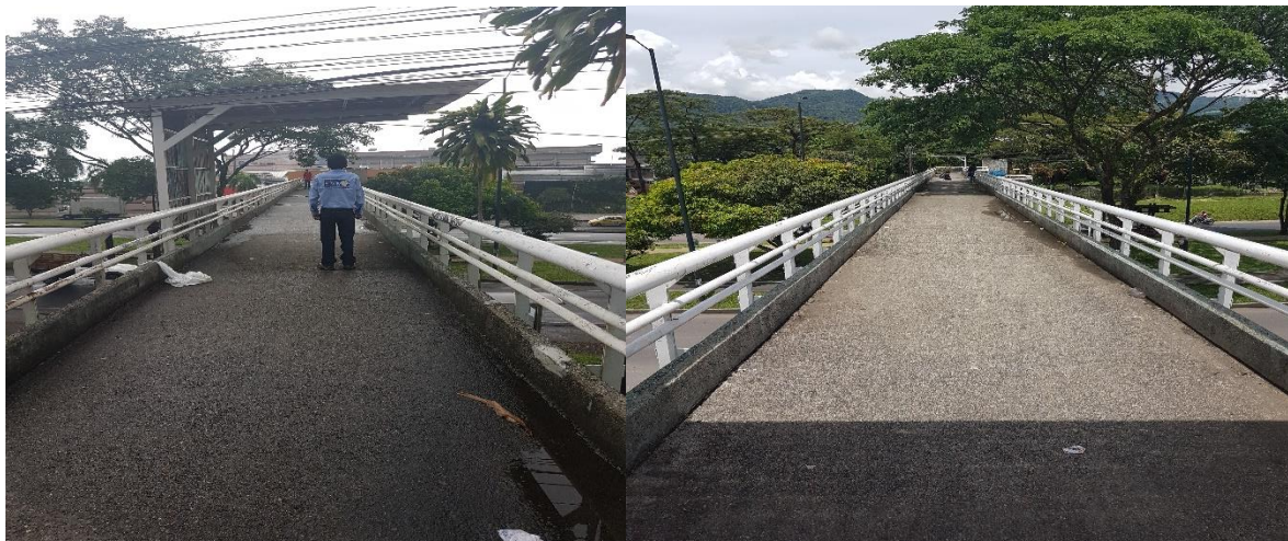
Figura 33. Patologías encontradas en losa o tablero del puente peatonal
