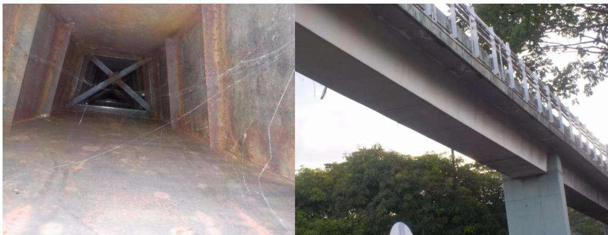
Figura 34. Patologías encontradas en viga metálica del puente peatonal
