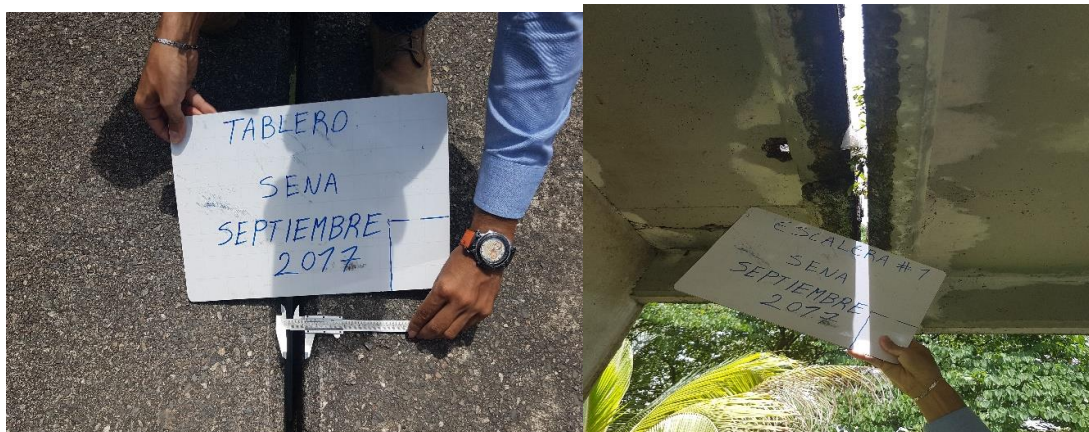
Figura 26. Patologías encontradas en juntas de dilatación en el puente peatonal Fuente: Los autores.
