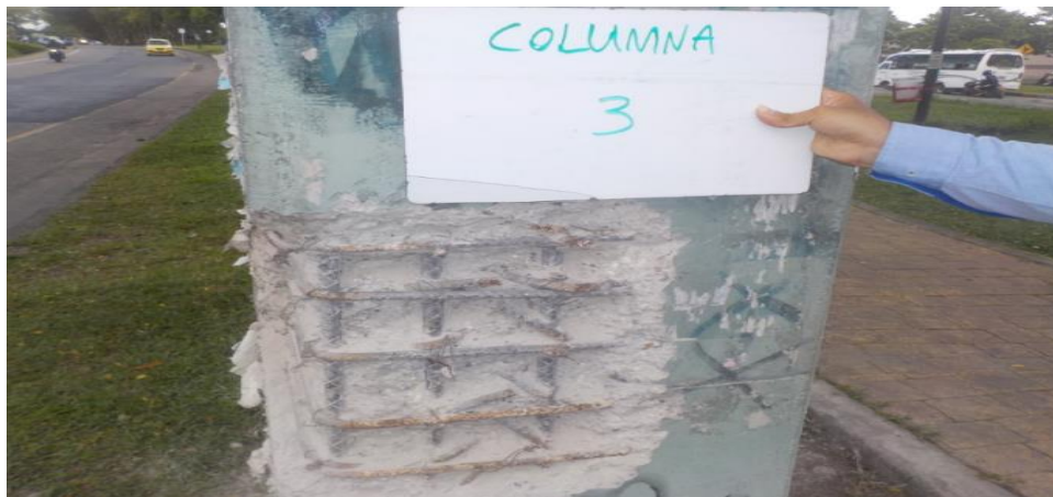
Figura 19. Regatas en columna 3
