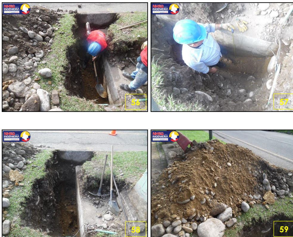
Figura 23. Exploración del apique para identificar el tipo de cimentación Fuente: Estudio de suelos
