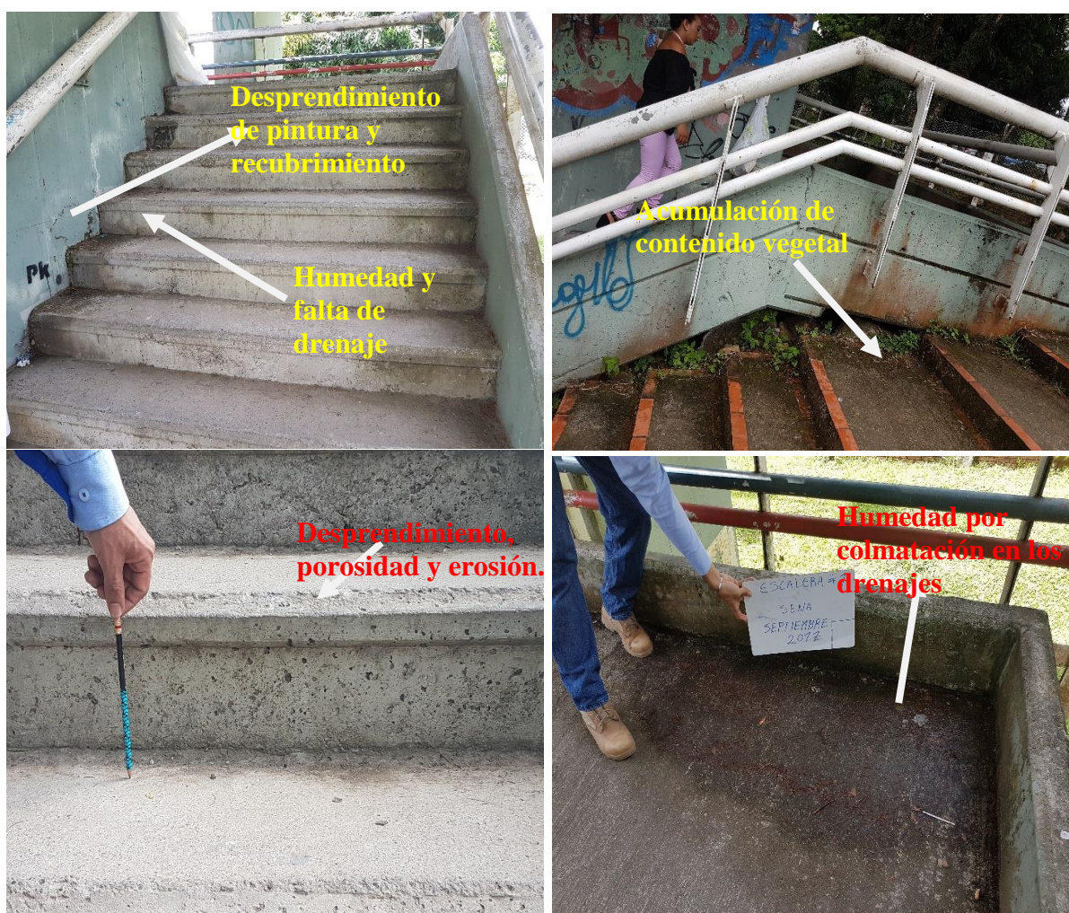
Figura 24. Patologías encontradas en la superficie del puente peatonal y accesos Fuente: Los autores.
