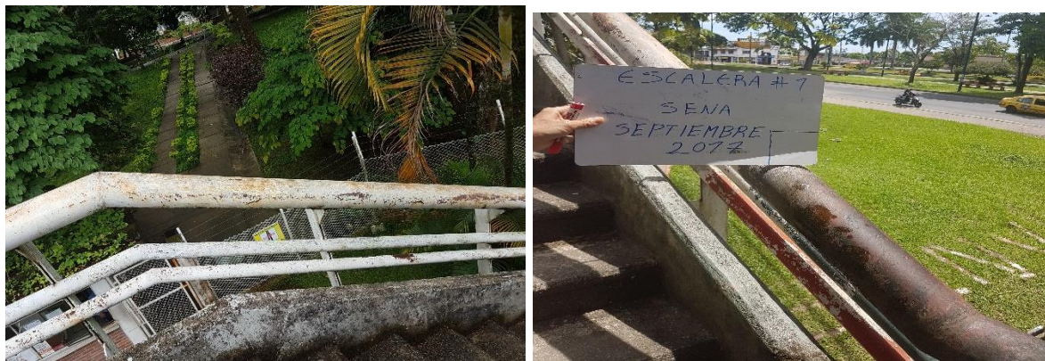
Figura 28. Patologías encontradas en barandas del puente peatonal Fuente: Los autores.
