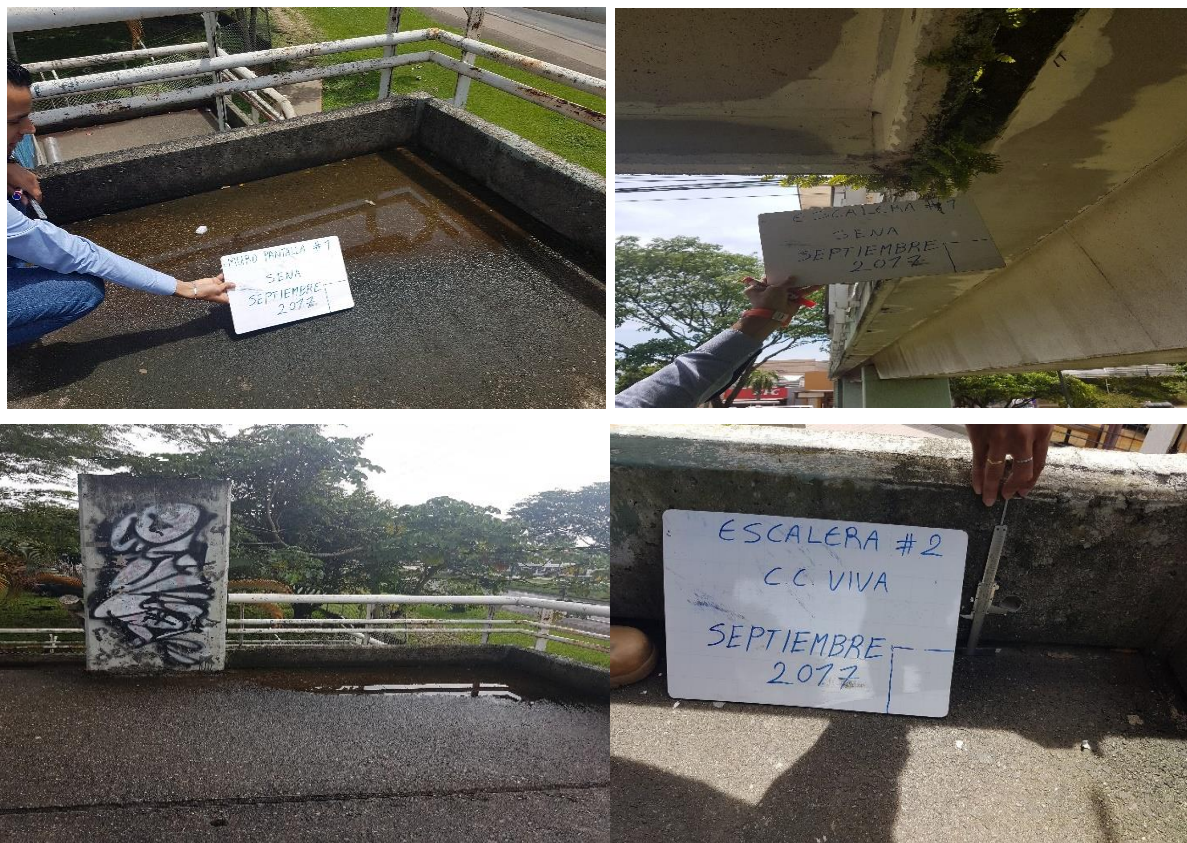
Figura 29. Patologías encontradas en drenajes del puente peatonal Fuente: Los autores.
