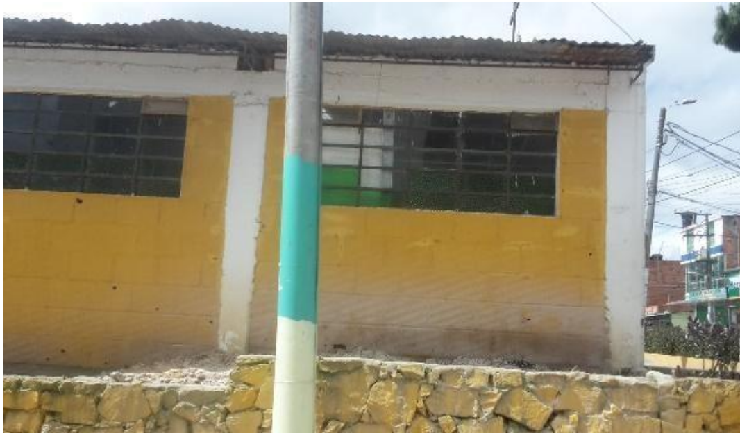
Ilustración 5. Estado del lado izquierdo de la construcción.
