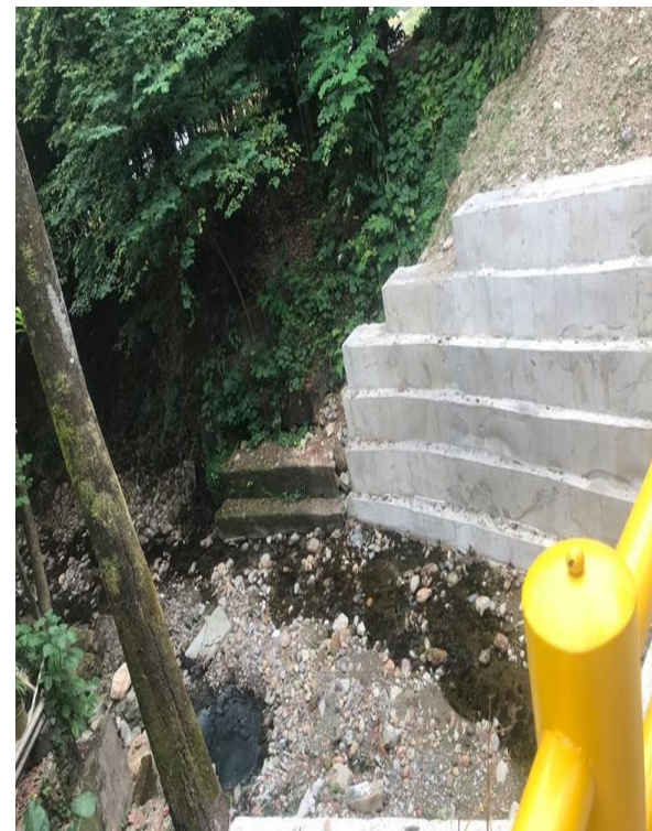
Zona de gaviones Caño Buque.
