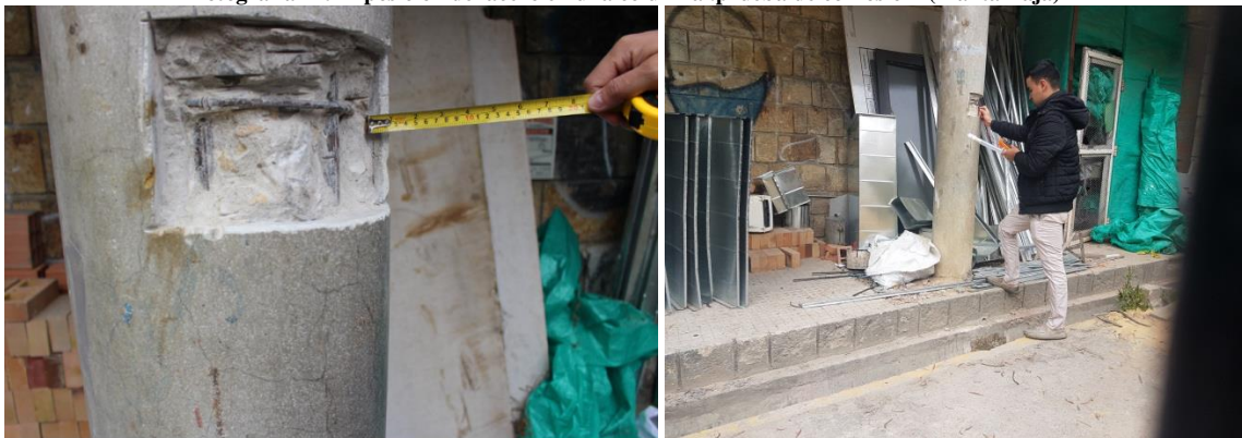
Fotografía 22. Exposición del acero en una columna .prueba de corrosión (Planta Baja)
