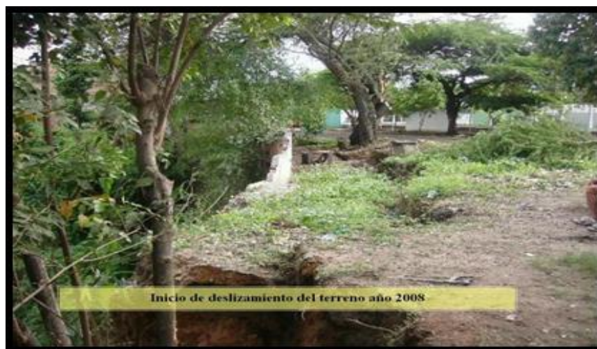
Ilustración 12 COLAPSO DEL MURO DE CONTENCIÓN
