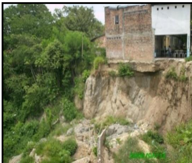
Ilustración 11 PROCESO DE SOCAVACIÓN Y AVERÍA DE VIVIENDA
