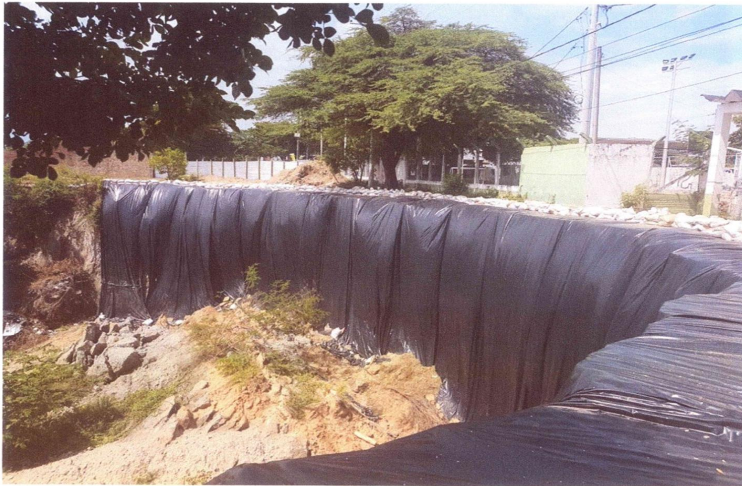
Ilustración 39 ZONA DE EROSIÓN
