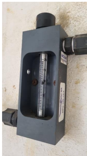
Figura 15. Medidor de cloración
