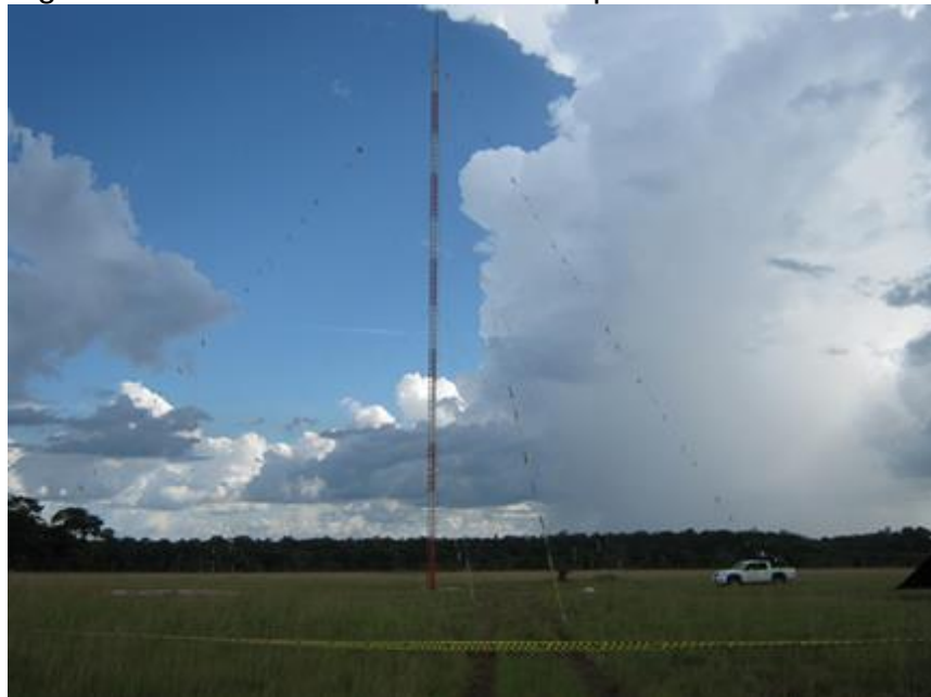
Fotografía 3. Torre venteada o riendada para telecomunicaciones
