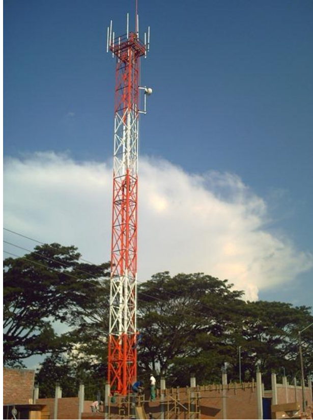
Fotografía 2. Torre autoportada para telecomunicaciones
