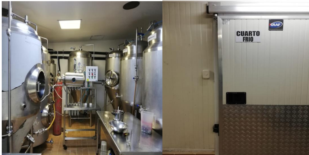
Figura 1. Tanques fermentadores y Cuarto frío.
