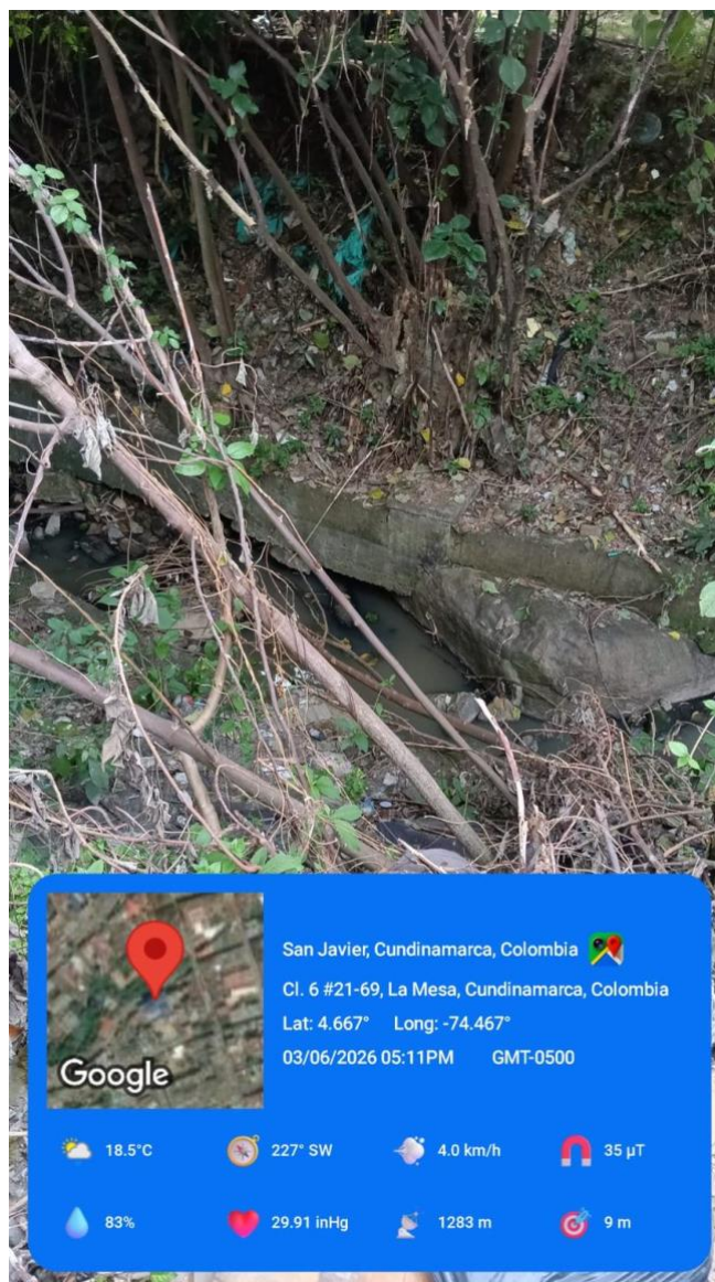
Figura 8 Punto 3. Talud con residuos y vegetación intervenida
