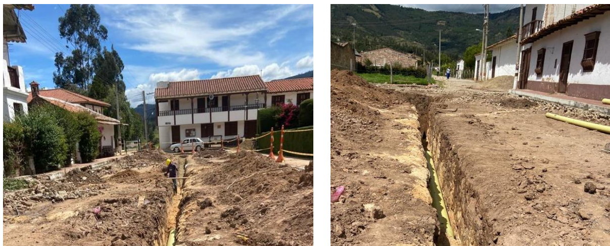
Figura 7. Incumplimiento del lugar de desinfección para el personal de obra.
