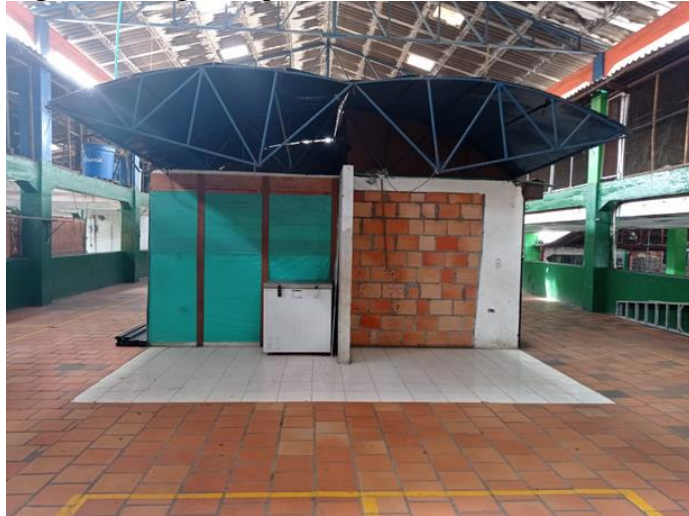
Figura 51. Segundo piso, locales abandonados, locales en mal estado.
