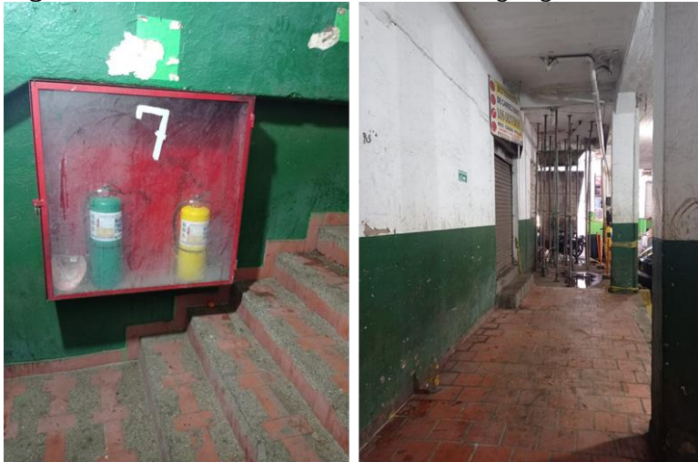
Figura 50. Mal estado de Zona de Descarga, gabinete contra incendios punto fijo escaleras.
