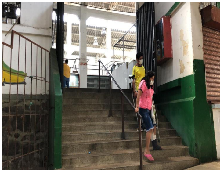
Figura 1. Escaleras área cárnica, no accesible.
