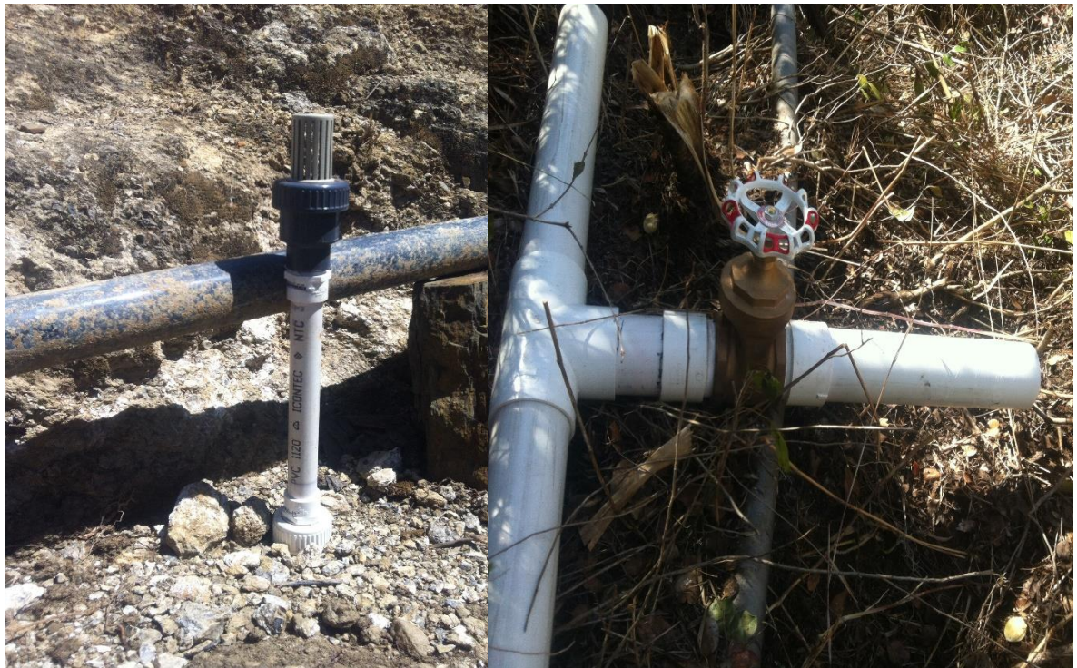
Ilustración 60. Ventosas y válvulas de purga.
