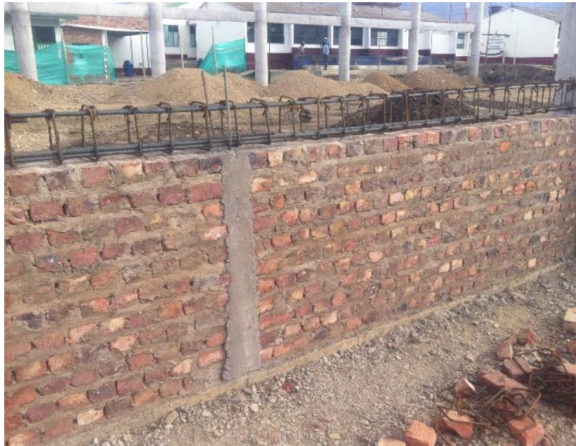
Ilustración 37. Columneta de confinamiento.
