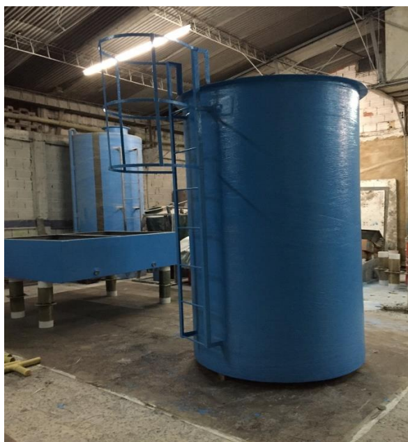
Ilustración 61. Planta de tratamiento.
