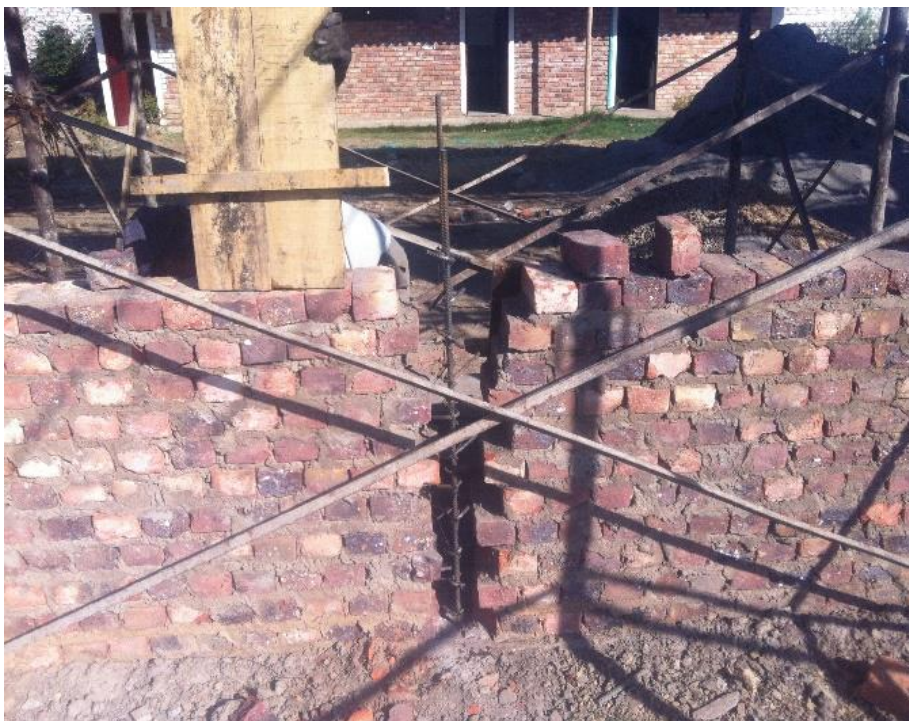
Ilustración 36. Área removida de muro.
