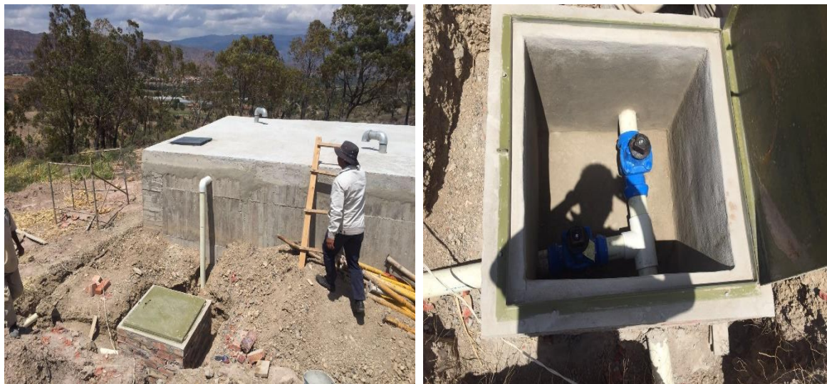
Ilustración 70. Cajas de inspección.
