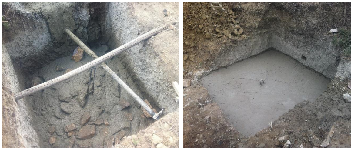
Ilustración 71. Muertos de anclaje.
