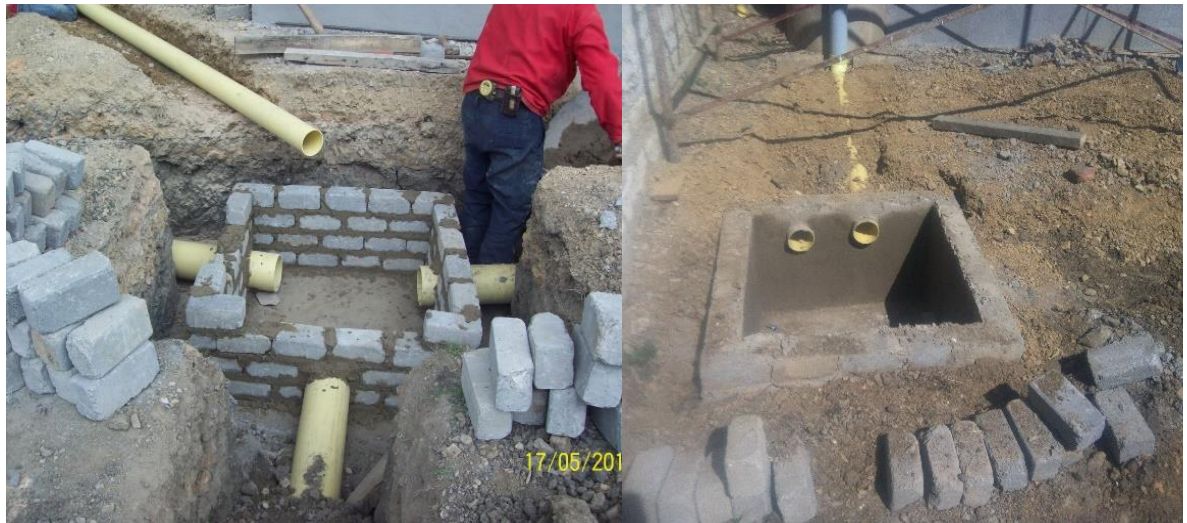
Ilustración 49. Cajas de inspección.
