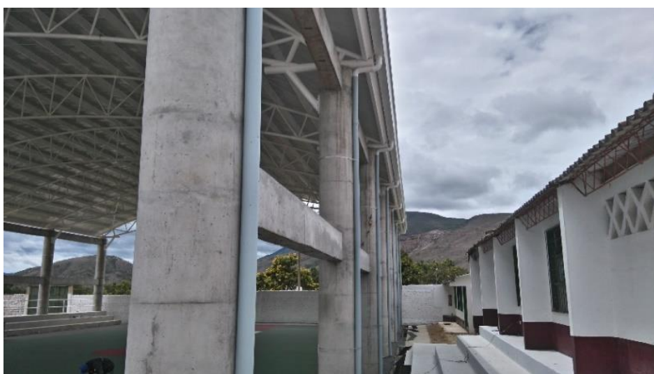
Ilustración 46. Bajantes aguas lluvias.
