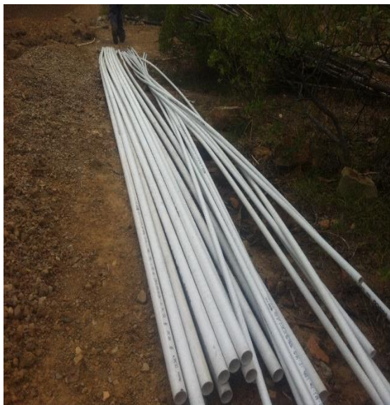
Ilustración 65. Tubería red de suministro.
