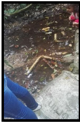
Imagen 4-3 Captación de agua Caño Fanagra. Fuente Autores
