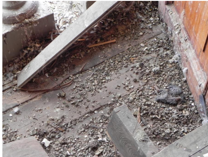
Figura 6. Deterioro interno de la construcción. Fuente: Propia
