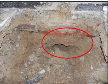
Afectación por humedad en sectores de la base.
