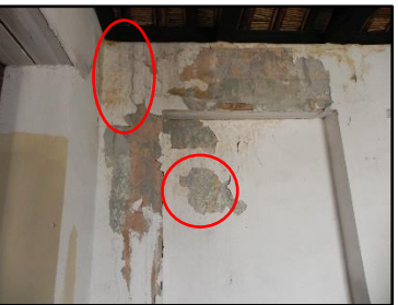
Coloración verdosa y machas amarillas por humedad.
