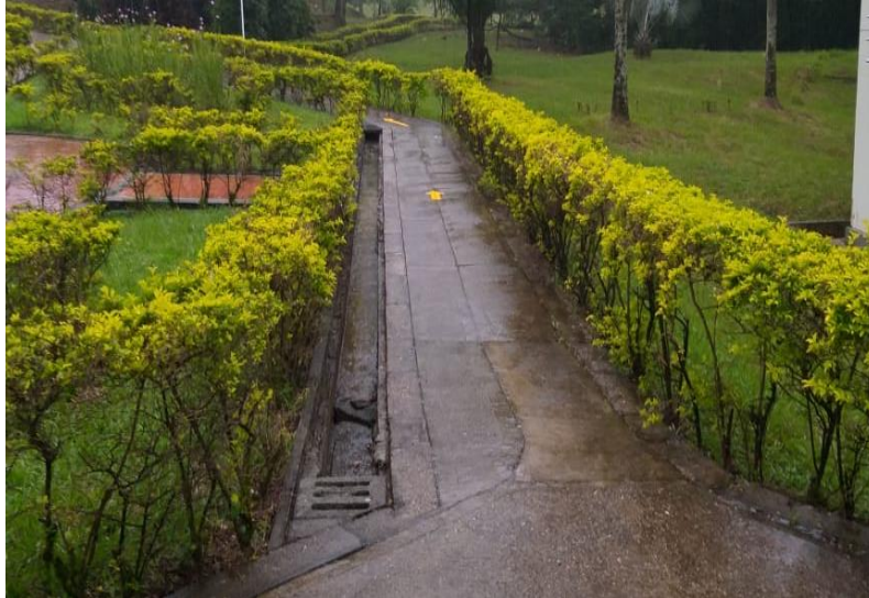
Figura 8.32 Deterioro en el canal de aguas lluvias del andén C, sendero desde la portería al bloque A (Julio 2020)
