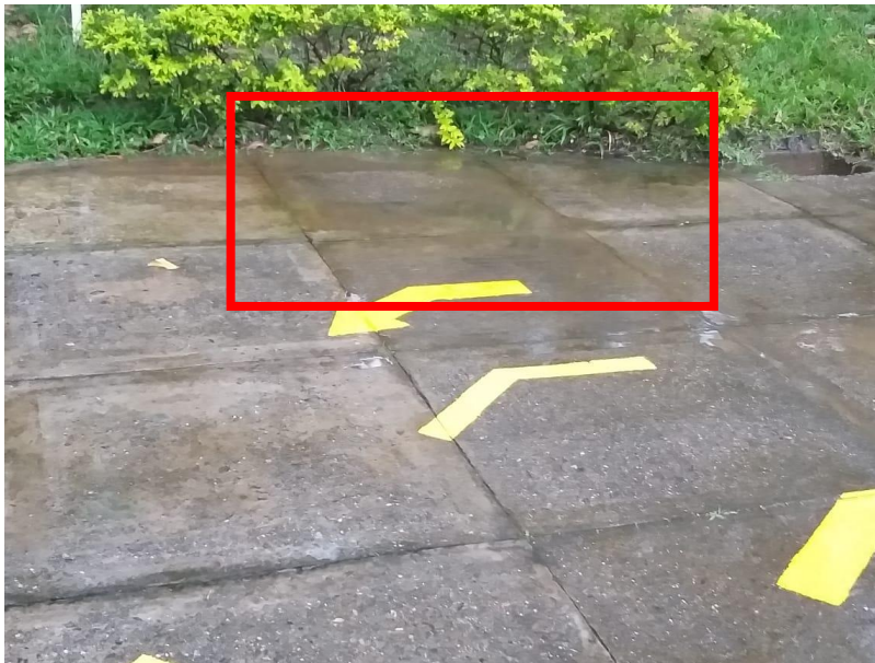
Figura 8.33 Inundación en zonas desniveladas del sendero peatonal (Julio 2020)
