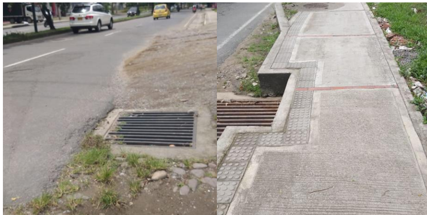
Figura 8.25 Rejillas – Tramo J y L (Julio 2020) Fuente: Elaboración propia a partir de inspección
