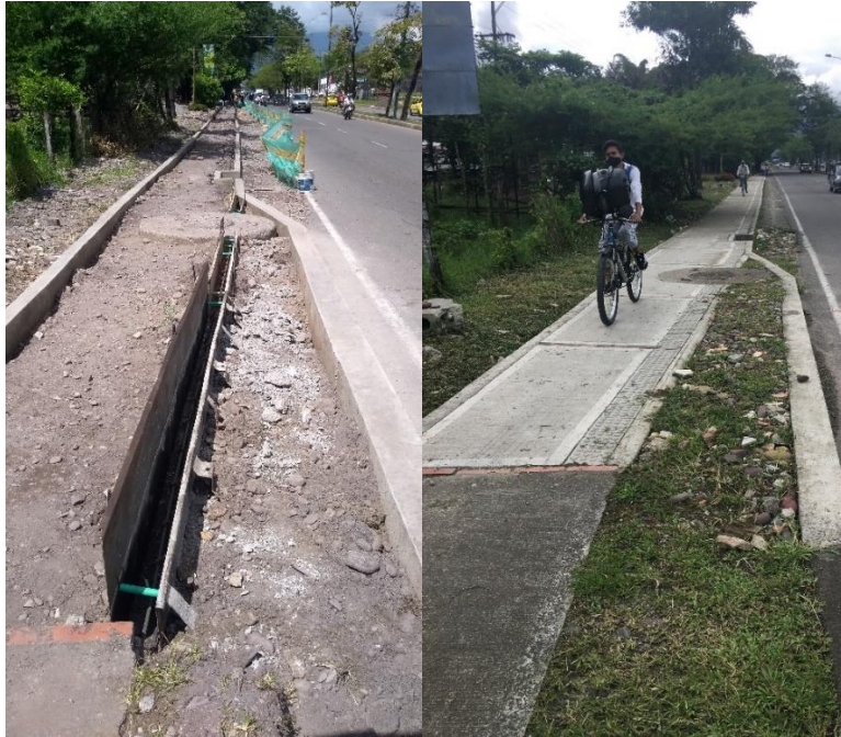
Figura 9.6 Izquierda Diciembre 2019 - Derecha Julio 2020 (Tramo L) Fuente: Elaboración propia a partir de inspección
