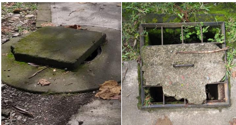
Figura 8.17 Tapas sobresalientes o rotas (Tramo A) (Julio 2020)
