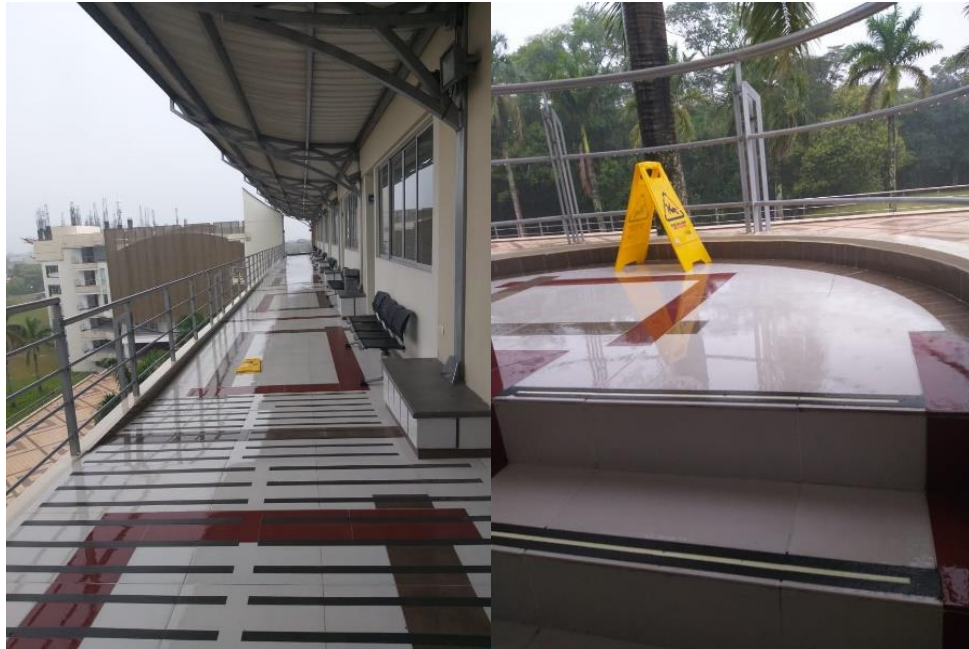
Figura 9.43 Día de lluvia en el Bloque A: Pasillo 5to piso y escaleras Fuente: Elaboración propia a partir de inspección
