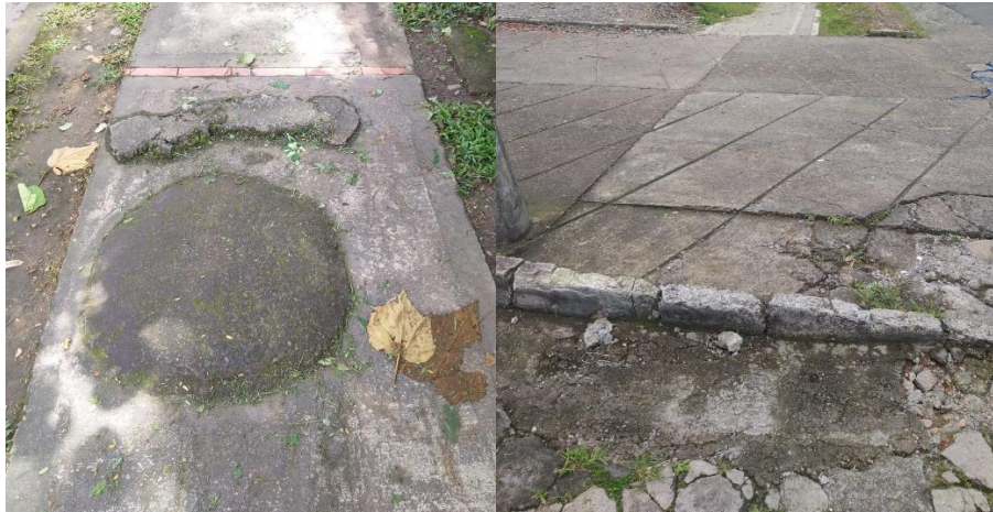
Figura 8.19 Resaltos o relieves de concreto – Tramo A y H (Julio 2020) Fuente: Elaboración propia a partir de inspección
