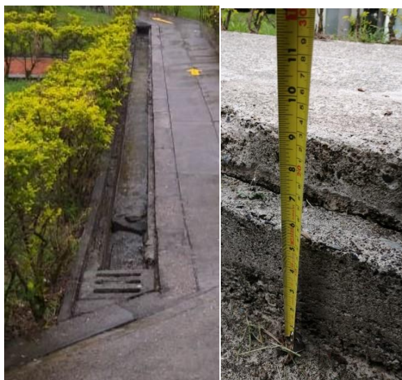
Figura 9.34 Rejilla deteriorada en el sendero que comunica la portería con el bloque B (Julio 2020)
