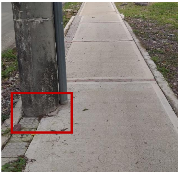
Figura 9.27 Obstrucción Señal Podotáctil (Poste) – Tramo G (Julio 2020) Fuente: Elaboración propia a partir de inspección
