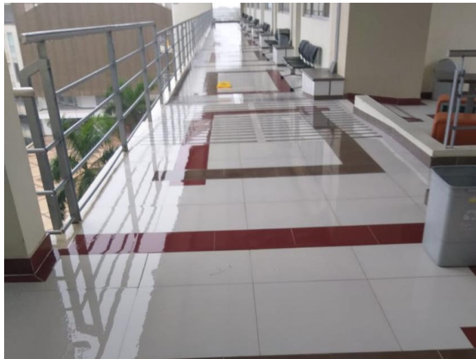
Figura 8.29 Inundación en el pasillo en el nivel 5 del bloque A (Julio 2020)
