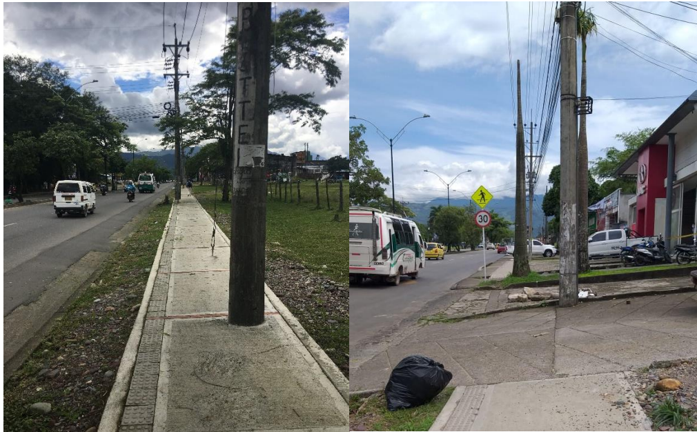
Figura 8.22 Postes – Tramo G y H (Julio 2020) Fuente: Elaboración propia a partir de inspección
