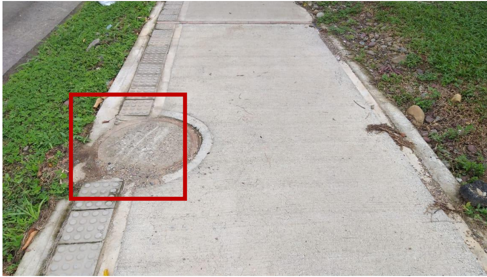
Figura 9.28 Obstrucción Señal Podotáctil (Tapa) – Tramo G (Julio 2020) Fuente: Elaboración propia a partir de inspección
