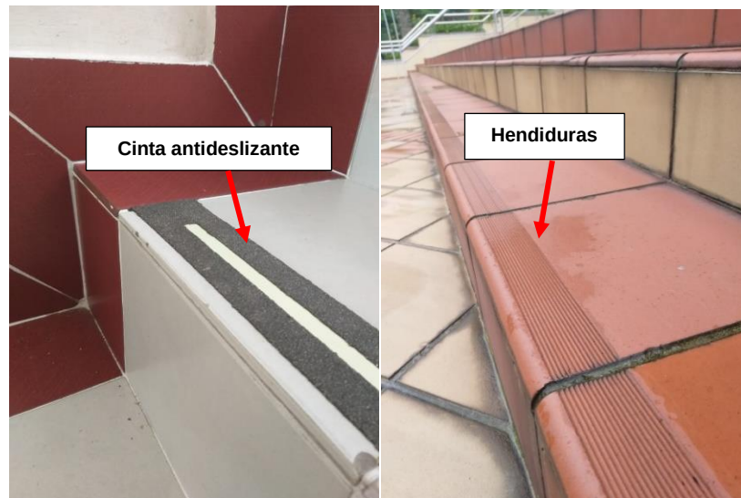
Figura 9.37 Izquierda Escalera con aristas en filo– Derecha Escalera con aristas redondeadas (Julio 2020)
