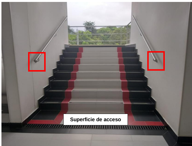
Figura 9.40 Ausencia de prolongación horizontal en los pasamanos de las escaleras del bloque B (Julio 2020)
