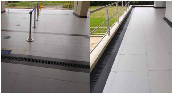
Figura 9.30 Canales de desagüe de aguas lluvia en el nivel 1 y 2 del bloque B (Julio 2020)
