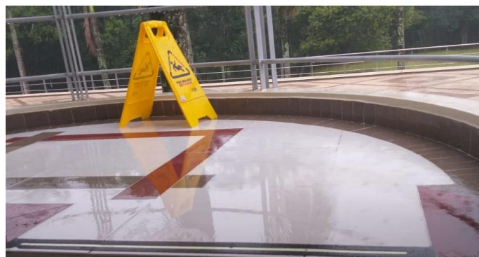
Figura 9.36 Descanso de las escaleras al costado derecho del bloque A (Julio 2020) Fuente: Elaboración propia a partir de inspección
