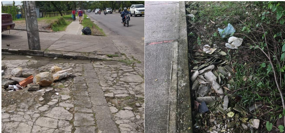
Figura 8.23 Escombros – Tramo H y L (Julio 2020) Fuente: Elaboración propia a partir de inspección
