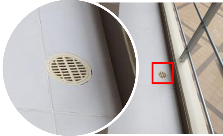
Figura 9.29 Sistema de drenaje de aguas lluvias en el nivel 2 del bloque A (Julio 2020)
