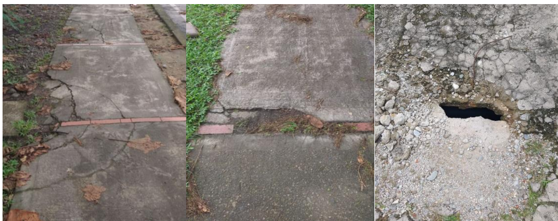
Figura 8.4 Deterioro Tramos A, B y H (Julio 2020)
