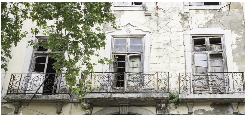
Ilustración 1, patologías de la construcción
