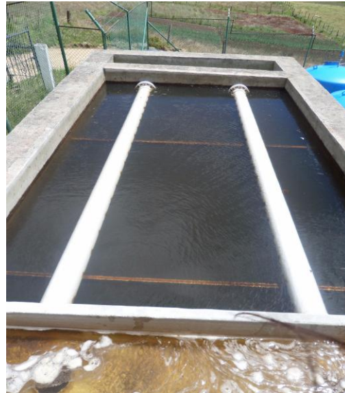
Imagen 6. Sedimentador de la PTAP de Guatavita
