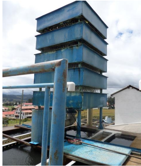
Imagen 4. Aireador de la PTAP de Guatavita
