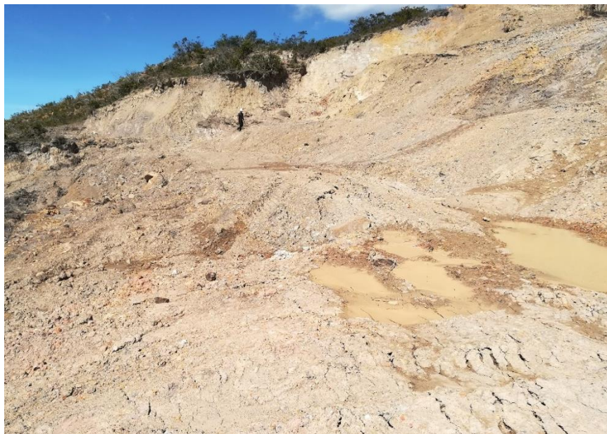
Ilustración 11. Afectación de aguas lluvias al proceso de estabilización.
