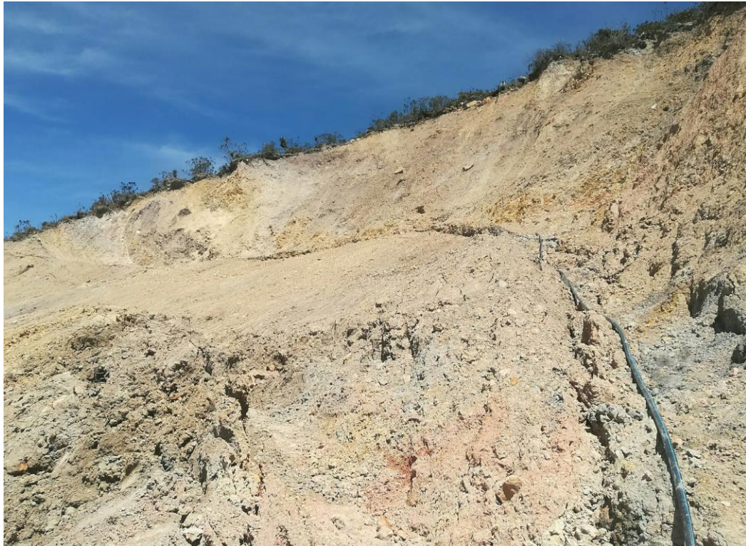
Ilustración 13. Drenaje provisional de aguas superficiales.
