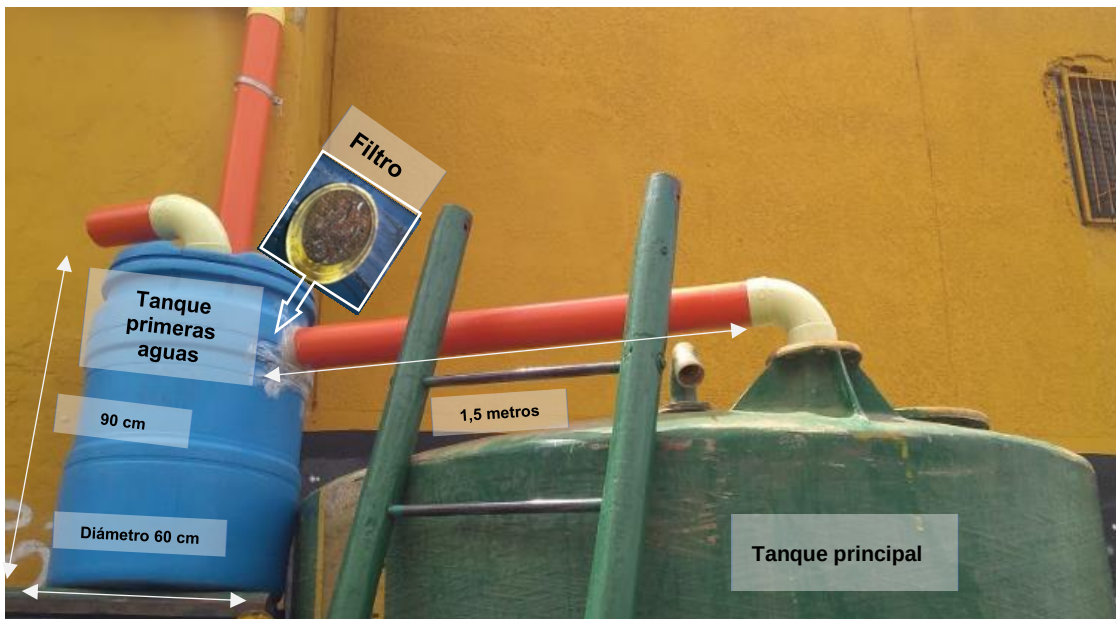
Fig 17. Sistema de captación de aguas lluvias
