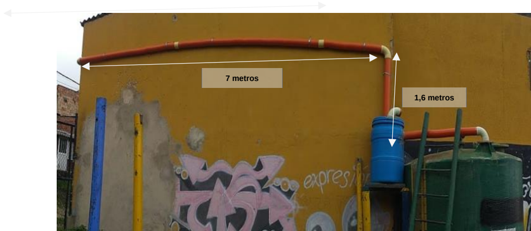
Fig 19. Bajante conectada al tanque de primeras aguas lluvias
