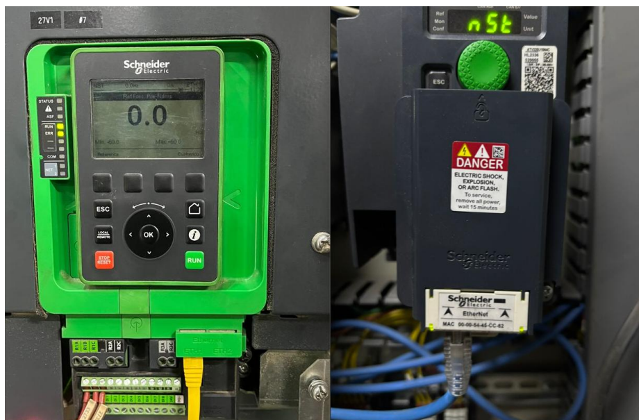
Figura 5. Variadores ATV930 y ATV320
