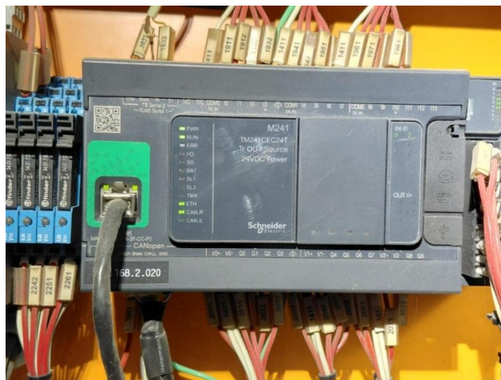
Figura 27. PLC M241 Schneider
