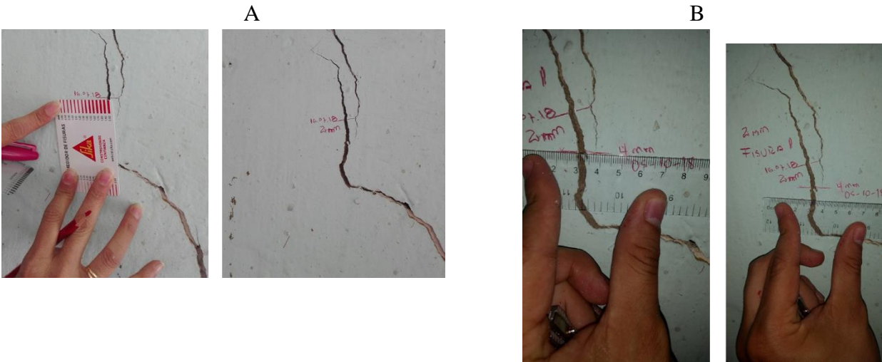
Figura 38 Seguimiento a Fisura 1
