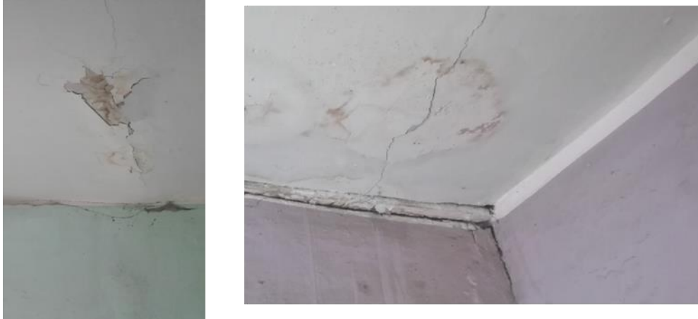
Figura 9 En la mayoría de zonas de la cubierta presenta deficiencias permitiendo filtraciones.
