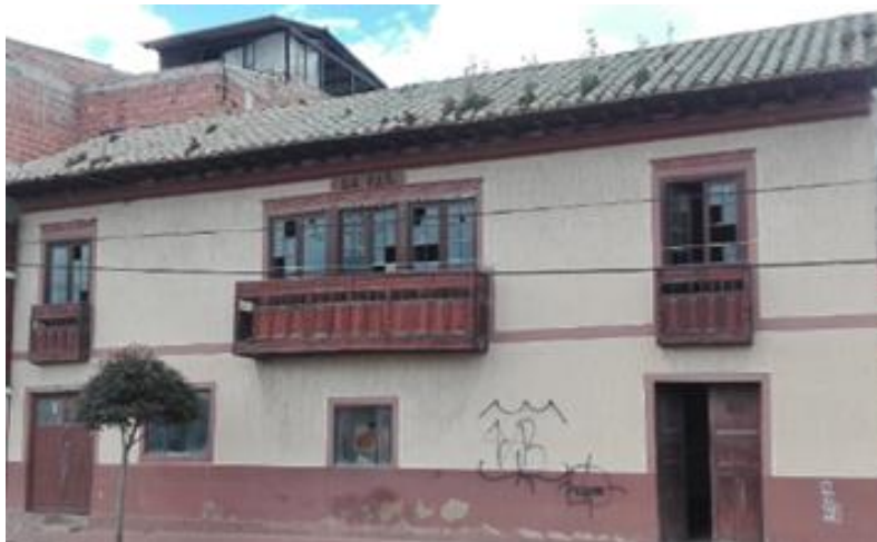
Figura 27 La fachada presenta en su totalidad pañetes de cal y cemento texturizado con proceso de carraplast y sobre esta pintura
