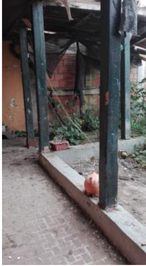
Figura 24 Con apariencia de desgaste el piso en zona de corredor y alcobas primer piso
