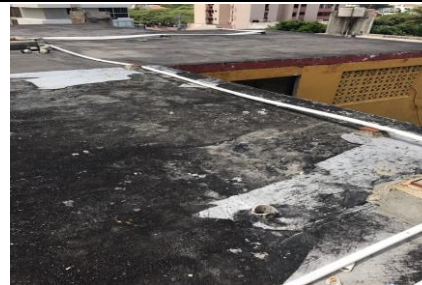
DETALLE CIELO RASO, CARA INFERIOR DE LA LOSA DE CUBIERTA, FUSURAS, CORROSION, DESPRENDIMIENTOS, HUMEDADES
