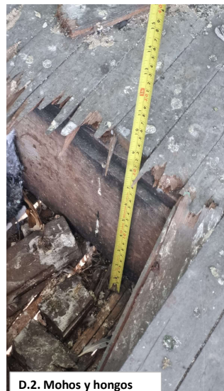
D.2. Mohos y hongos
