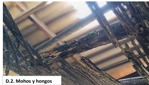
D.2. Mohos y hongos
