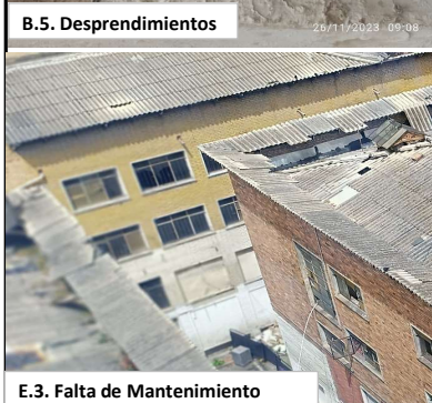
E.3. Falta de Mantenimiento
