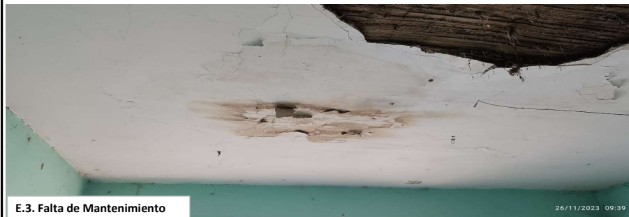
E.3. Falta de Mantenimiento
