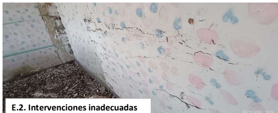
E.2. Intervenciones inadecuadas
