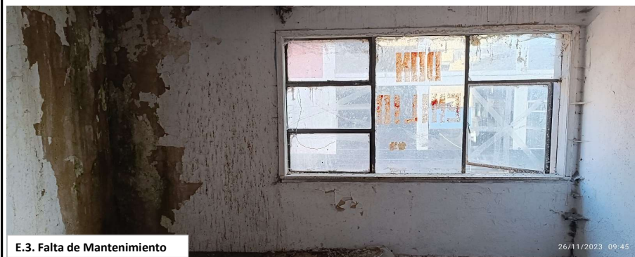
E.3. Falta de Mantenimiento
