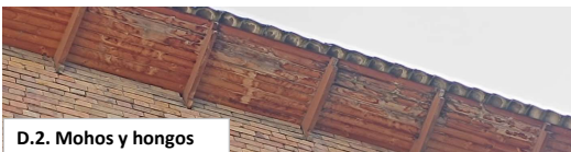
D.2. Mohos y hongos
