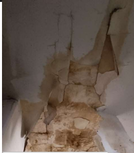
Humedad en HALL
