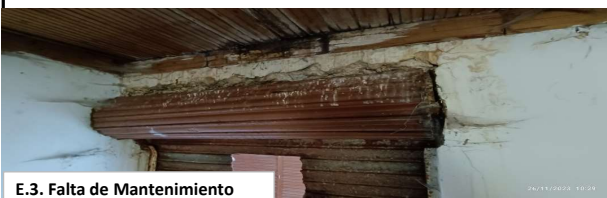
E.3. Falta de Mantenimiento
