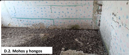
D.2. Mohos y hongos
