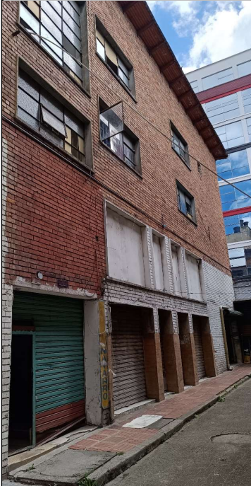
E.3. Falta de Mantenimiento
