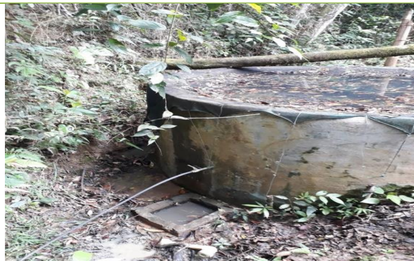
Fotografía 12 Tanque almacenamiento Finca Privada.
