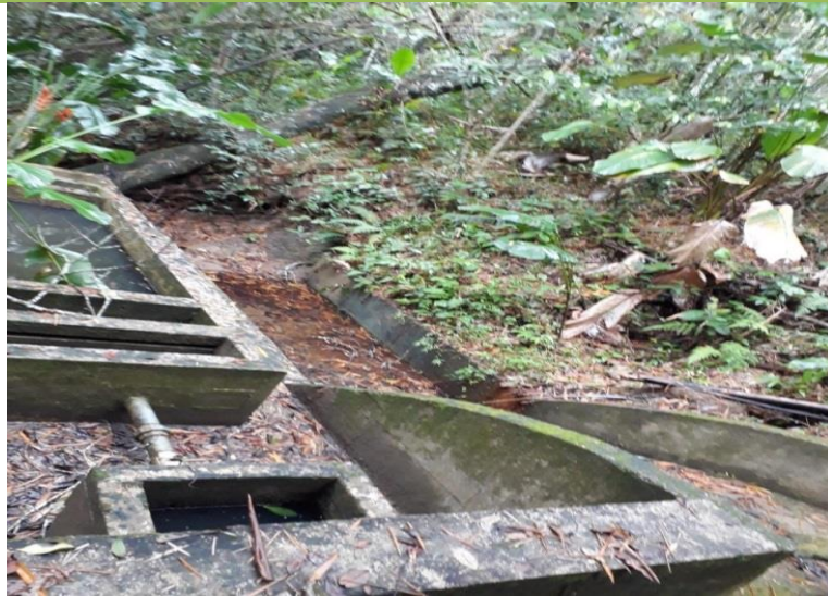
Fotografía 15 Tanque desarenador Lomalarga.
