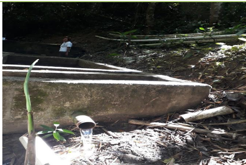
Fotografía 18 salida del tanque desarenador.
