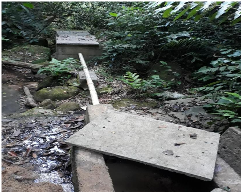
Fotografía 3 Bocatoma Aljibe Guayaquil.
