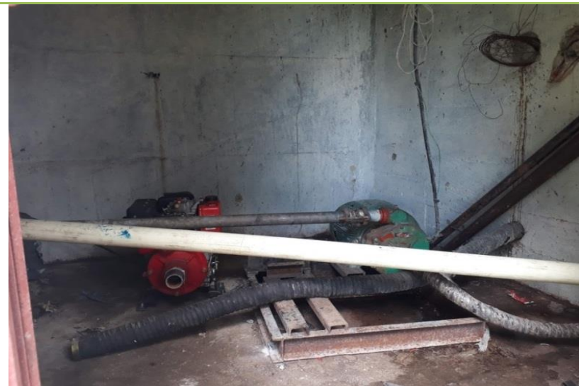
Fotografía 8 Moto Bomba, conduce el agua desde Talipa hasta las Veredas.
