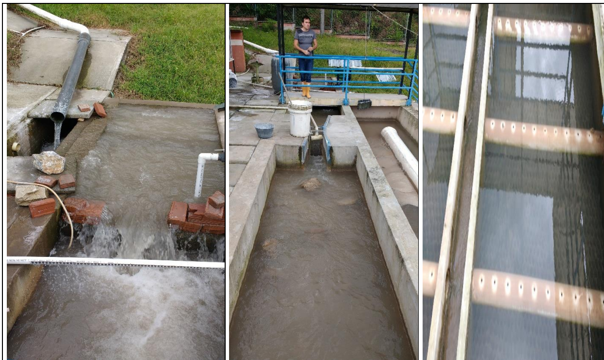
DESCRIPCIÓN: Canaleta Parshall y cámara de floculación
