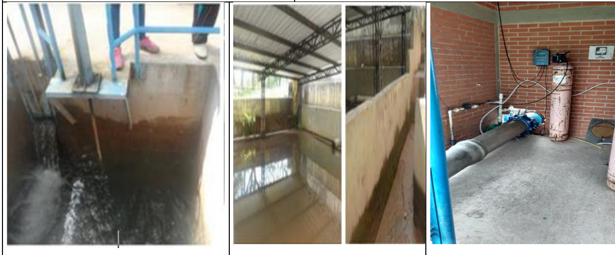
DESCRIPCIÓN: Filtros descendentes y Tanque de cloración manual
